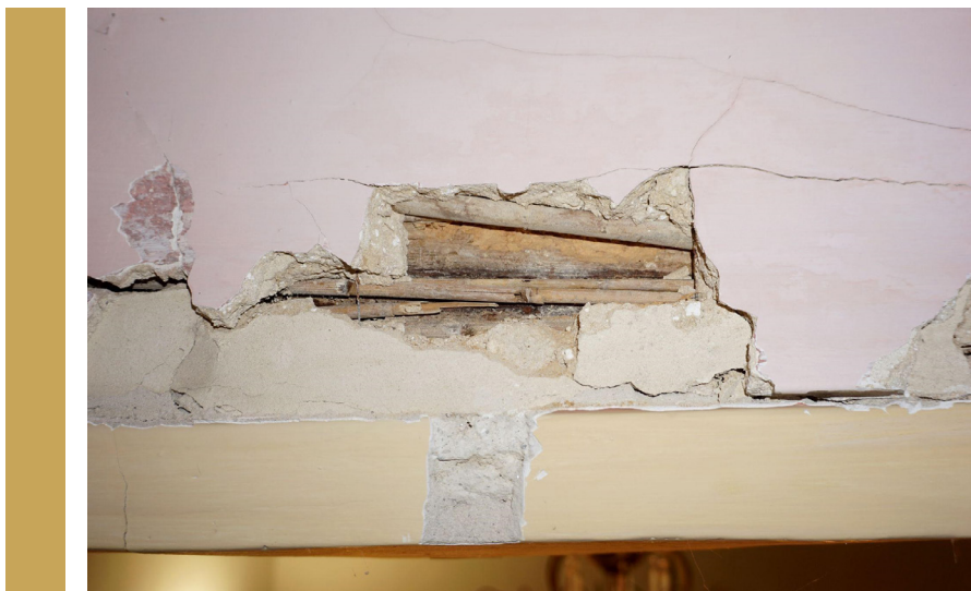
Slika 2: Konstrukcijske poškodbe na lesenem stopnem nosilcu, trstiki in ometu v slavnostni dvorani (Foto: Anja Urbanc, 2024)
