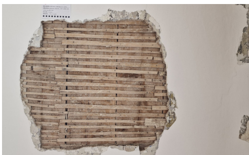
Slika 1: Pogled na strop v prostoru N30 in večji odpadel del pred posegom (Foto: Tanja Mesojedec, 2024)
