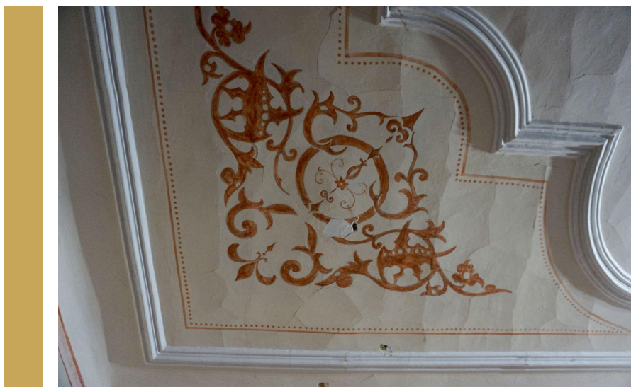
Slika 1: Razpokan stropni omet s šablonsko poslikavo in štukaturnim okrasjem v grajskem salonu (Foto: Anja Urbanc, 2024)
