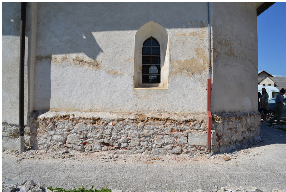
Slika 3: Vidne sledi delovanja kapilarne vlage v zidovih in odstranitev škodljivega cementnega obrizga na talnem zidcu (Foto: Ana Krevelj, 2025)
