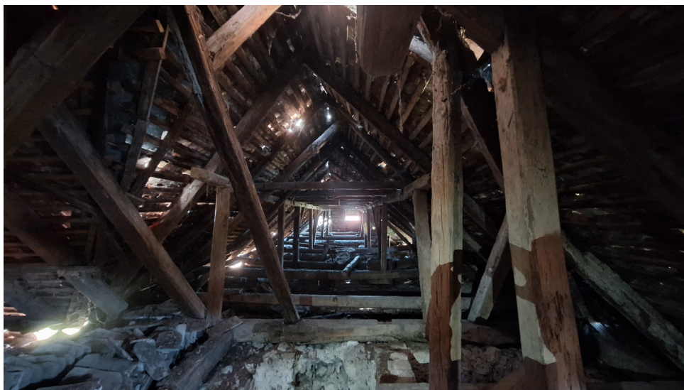
Slika 2: Stanje dotrajane strešne konstrukcije na SZ traktu dvorca (Foto: Dušan Štepec, 2025)
