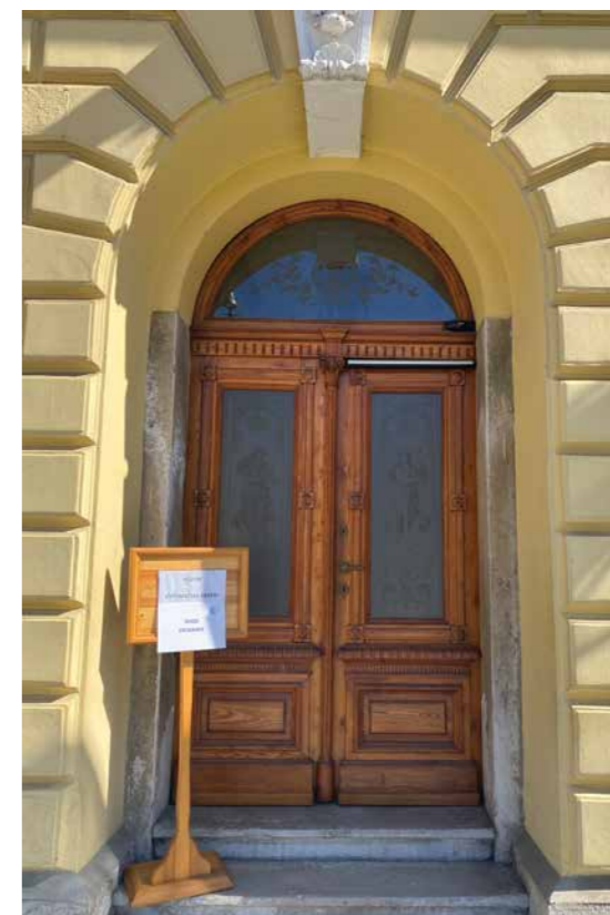
17 Ljubljana – filharmonija, avtomatizirana vhodna vrata. Foto: T. Hohnec, 2025
