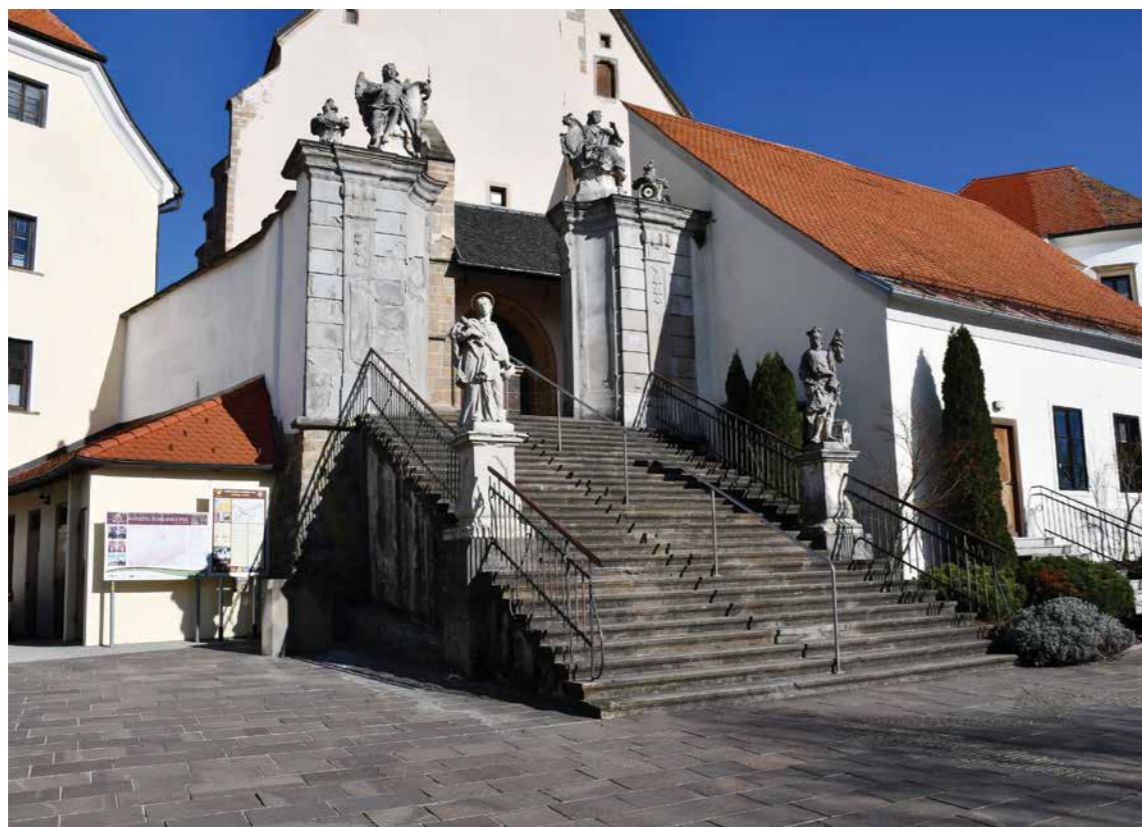
23 Stanje po odstranitvi dvigala ob levi strani stopnišča, ki vodi do vhoda v cerkev na Ptujski Gori. Foto: S. Menoni, 2024
