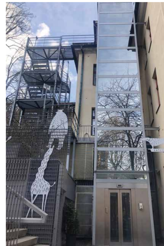
20, 21 Dvigalo s požarnim stopniščem na zadnji fasadi Mestnega doma, ki je vidno z javnih površin. Slika 20 - foto: R. Peskar, 2011; Slika 21 - foto: T. Hohnec, 2023
