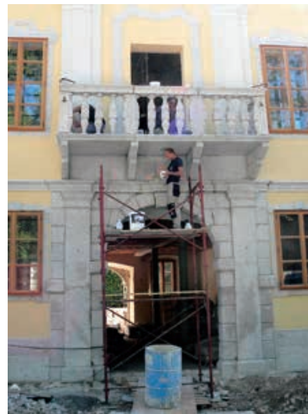
Lantherijeva graščina v Vipavi, konserviranje-restavriranje kamnitega balkona (foto: Mitja Mozetič, arhiv ZVKDS, Območna enota Nova Gorica)
