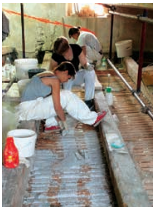
Lantherijeva graščina v Vipavi, konservatorji-restavratorji pri utrjevanju konstrukcije lesenega stropa (foto: Andrej Jazbec, arhiv ZVKDS, Območna enota Nova Gorica)
