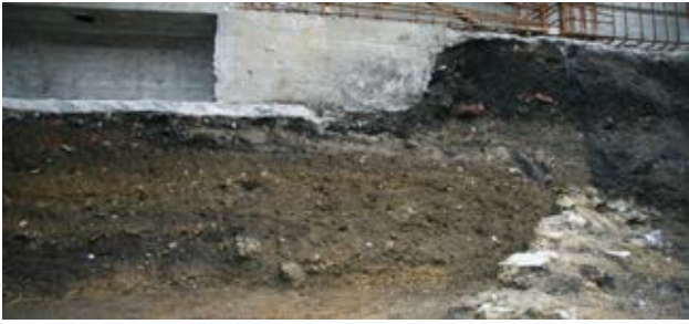
436 Faza 3, parcela J8. Poškodba zidu SE 5170 na brežini. Pogled proti severu.
