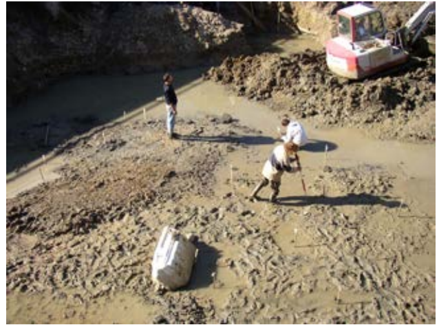
707 Polovica marmorne baze nagrobnega spomenika (v ospredju) je ležala tik nad ohranjenimi vrhovi pilotov drugega stebra mostne konstrukcije.
