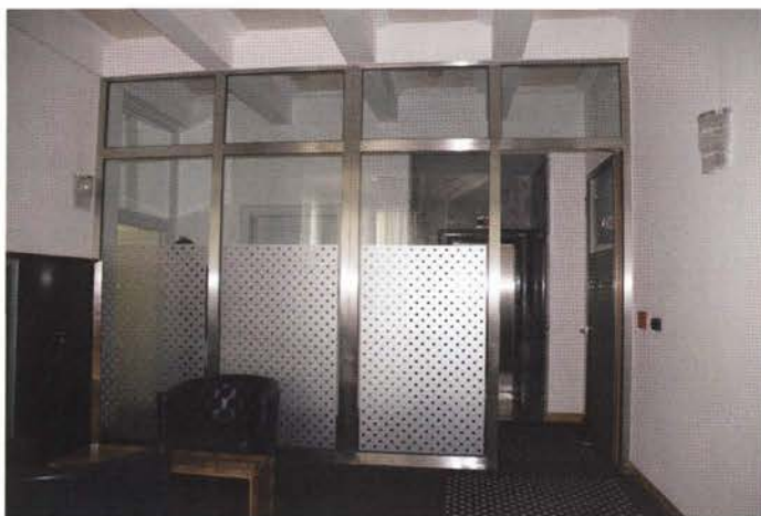
Neustrezna pregradna stena na hodniku.
