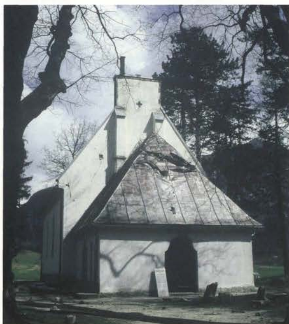
Porušena zvonica in poškodovana streha vhodne lope.
