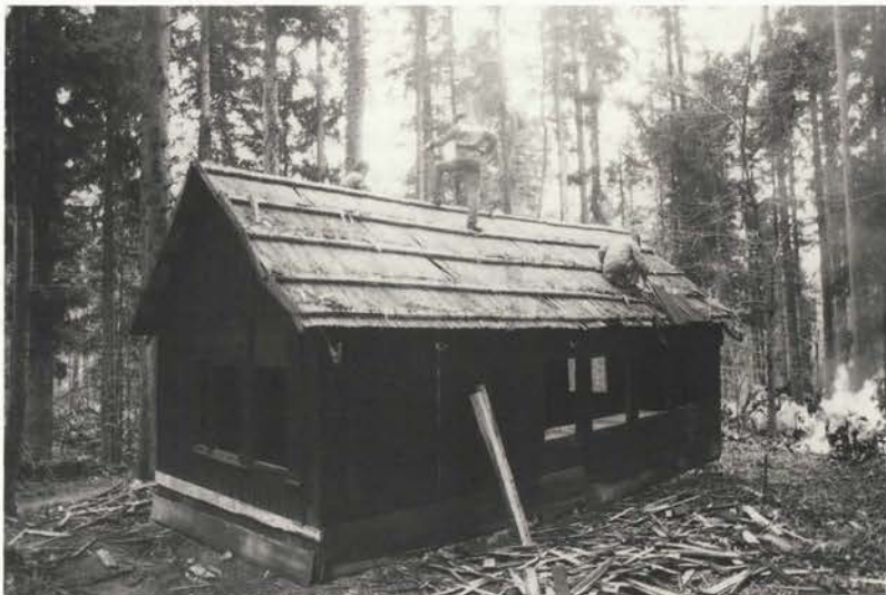
Baraka št. 16 med obnovo. ...»Odločili smo se za kritino skodel v treh plasteh, ki je trajnejša od prvotne v dveh plasteh...«
