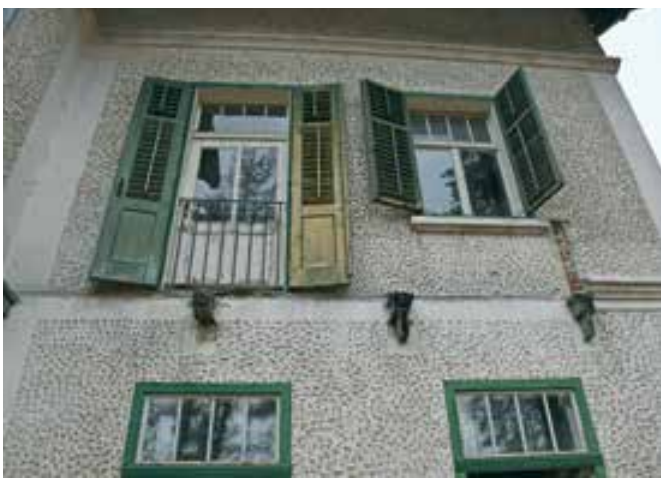
Bled, vila Savska cesta 2, detajl fasade pred pričetkom del (foto: M. Remškar)
