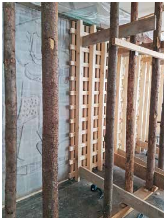
Trbovlje, strojna tovarna, dodatna zaščita z leseno mrežno konstrukcijo (foto: M. Lesar Kikelj, 2019)
