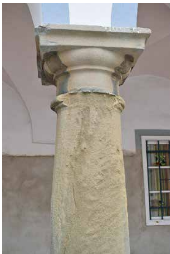
Ptuj, minoritski samostan, erodirana in poškodovana površina kamnitih stebrov (foto: K. Rus)
