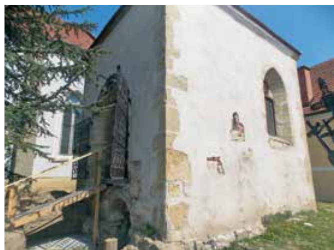
Križevci pri Ljutomeru, kapela sv. Ane, zunanščina med obnovo (foto: N. Kiš, 2017)
