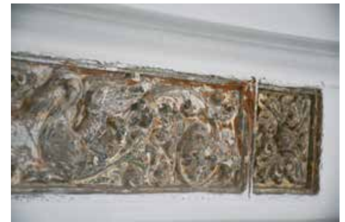
Kranj, hiša Prešernova ulica 11, primer glinene ploščice po čiščenju (foto: M. Remškar)
