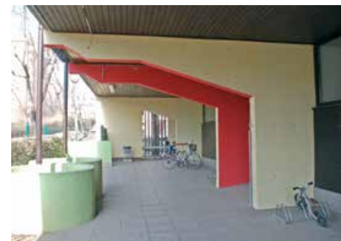
Ljubljana, vrtec Ajda, opleskane betonske konzole v pritličju zahodnega trakta pred prenavo (foto: Tatjana Adamič)
