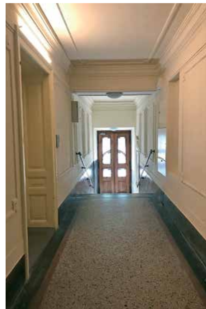
Ljubljana, hiša Cigaletova ulica 5, pogled na vežo po obnovitvenih delih (foto: M. Režek Kambič, 2020)
