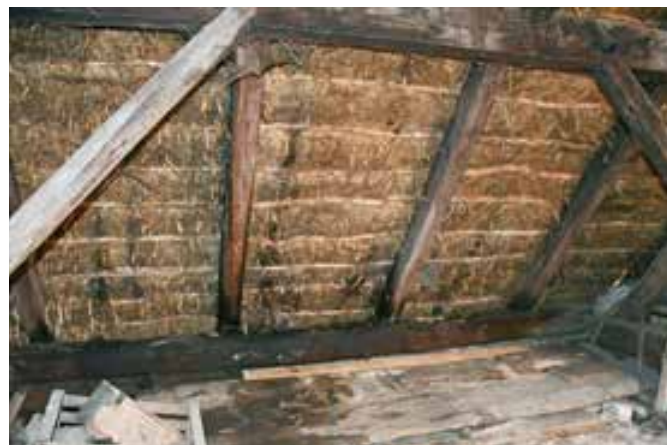
Območje dotrajane slame z zamakanjem na podstrešju Možinotove kašče (foto: A. Ščukovt, 2019)
