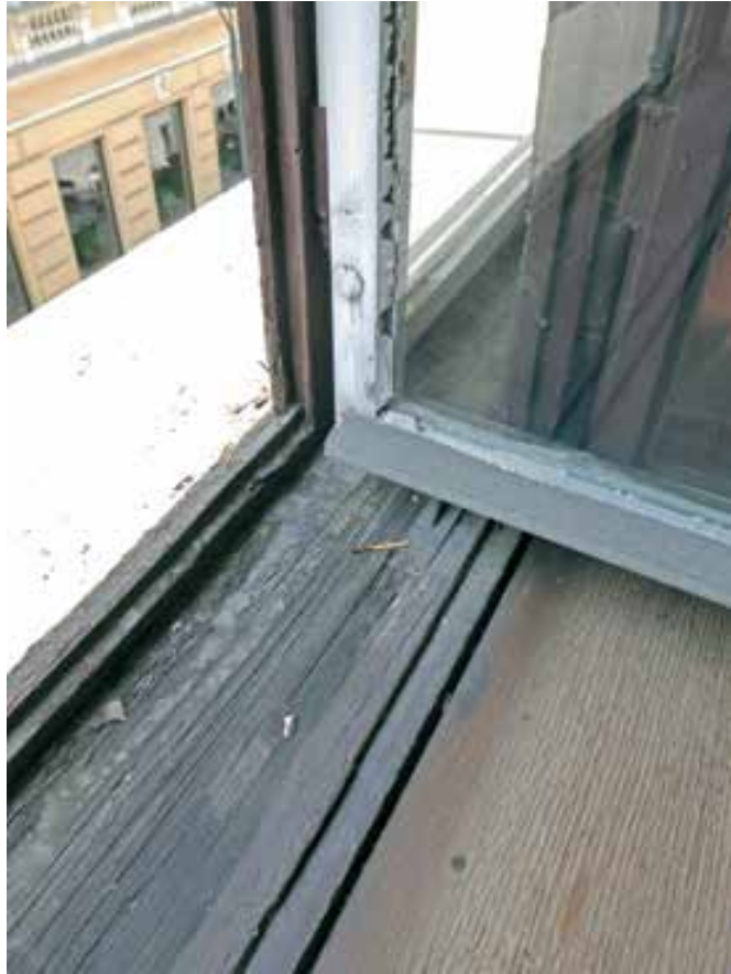
Celje, Celjski dom, detajl poškodovanega stavbnega pohištva v drugem nadstropju zahodnega krila (foto: M. Plevnik)
