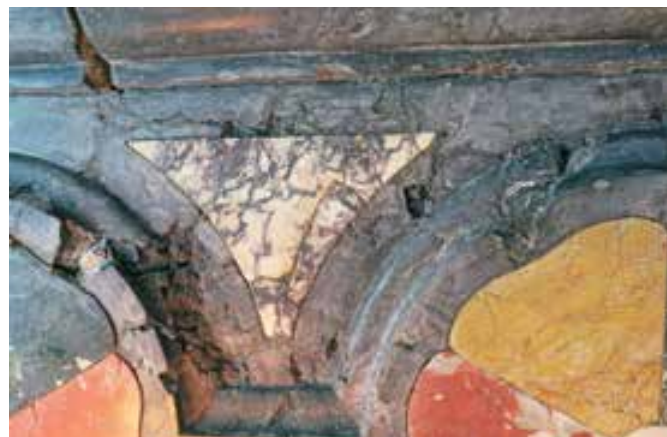
Blejski otok, cerkev Marijinega vnebovzetja, poškodbe na kamniti substanci menze oltarja sv. Mihaela (foto: S. Stržinar Sterle)
