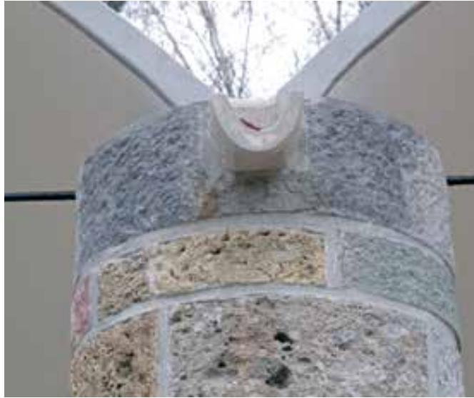
Kranj, lopa v Prešernovem gaju, urejen odtok v skladu s prvotnim načrtom arh. M. Šorlija (foto: Jaka Grmek)
