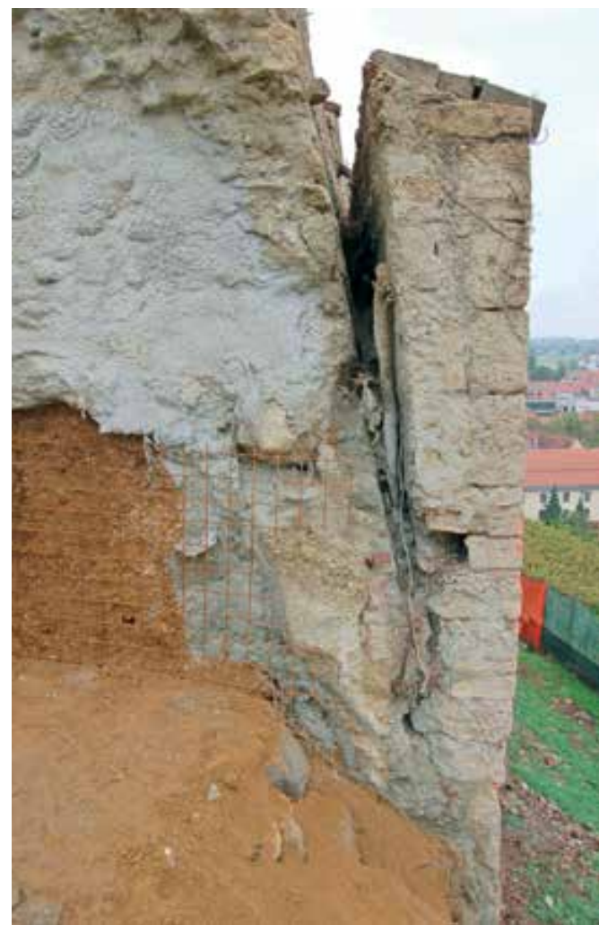
Ptuj, poškodba skrajno jugovzhodnega dela grajskega obzidja pred sanacijo (foto: S. Menoni Muršič)
