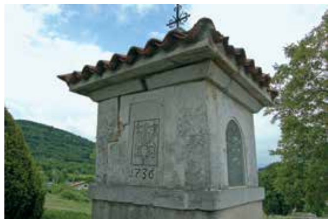
Dane pri Sežani, poškodovani pil pred obnovo (foto: E. Belingar, 2019)
