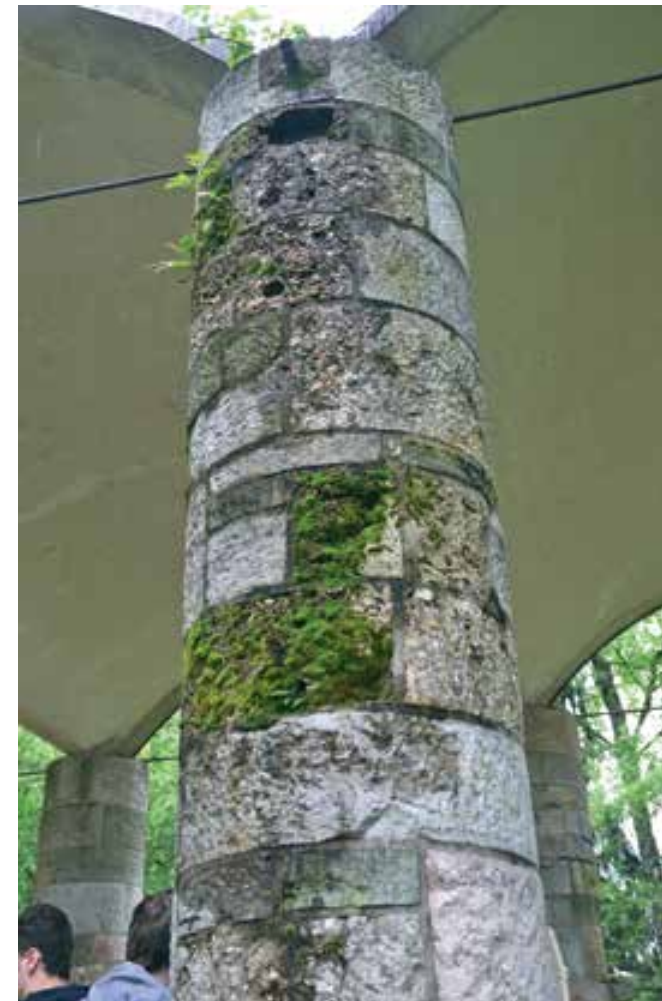
Kranj, lopa v Prešernovem gaju, vegetacija in poškodbe stebrov (foto: Ana Resnik)
