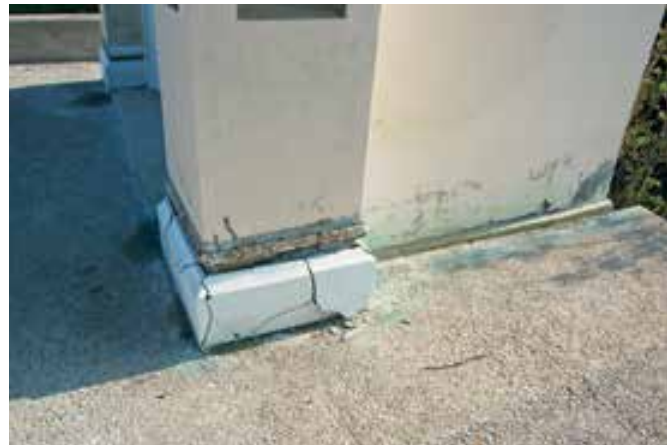
Planina, kapelica v Dolnji Planini, hude poškodbe so se pojavile predvsem na bazah stolpičev, okvirju vrat in na spodnjem delu zunanjih sten (foto: E. Belingar, 2018)
