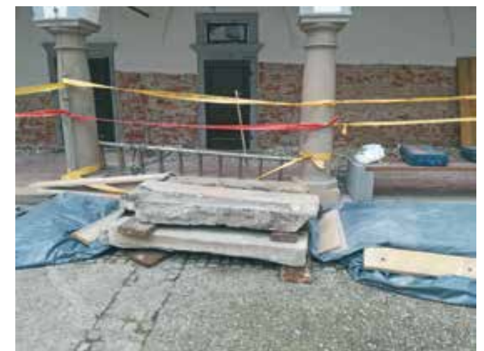
Ptuj, minoritski samostan, odstranjene kamnite stopnice in tlaki, odbiti ometi (foto: S. Menoni Muršič)
