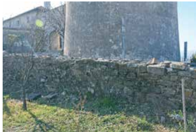
Šmartno v Brdih, podporni zid na Podratah, stanje pred obnovo (foto: A. Ščukovt, 2019)
