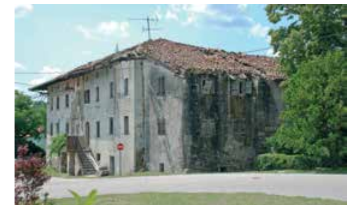
Drnovk 8 in 9, stanje pred obnovo strehe stavbe št. 9 (foto: A. Ščukovt, 2013)
