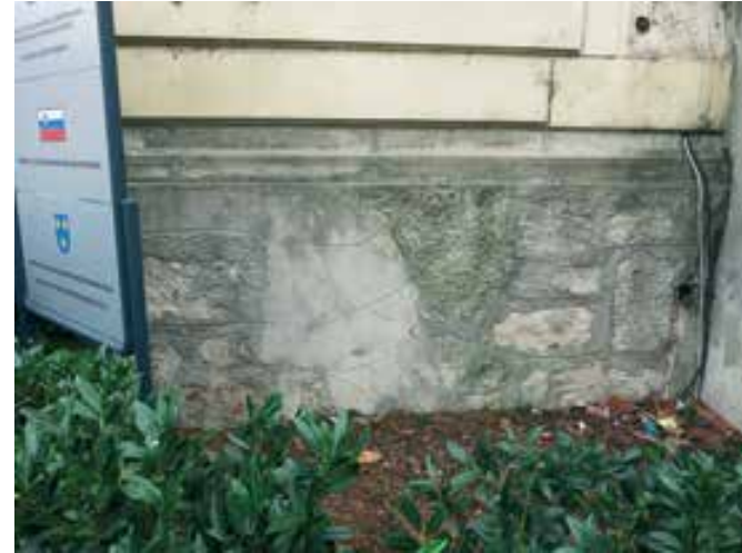
Celje, Celjski dom, neustrezna cementna mašila v kamnitem talnem zidcu (foto: M. Plevnik)
