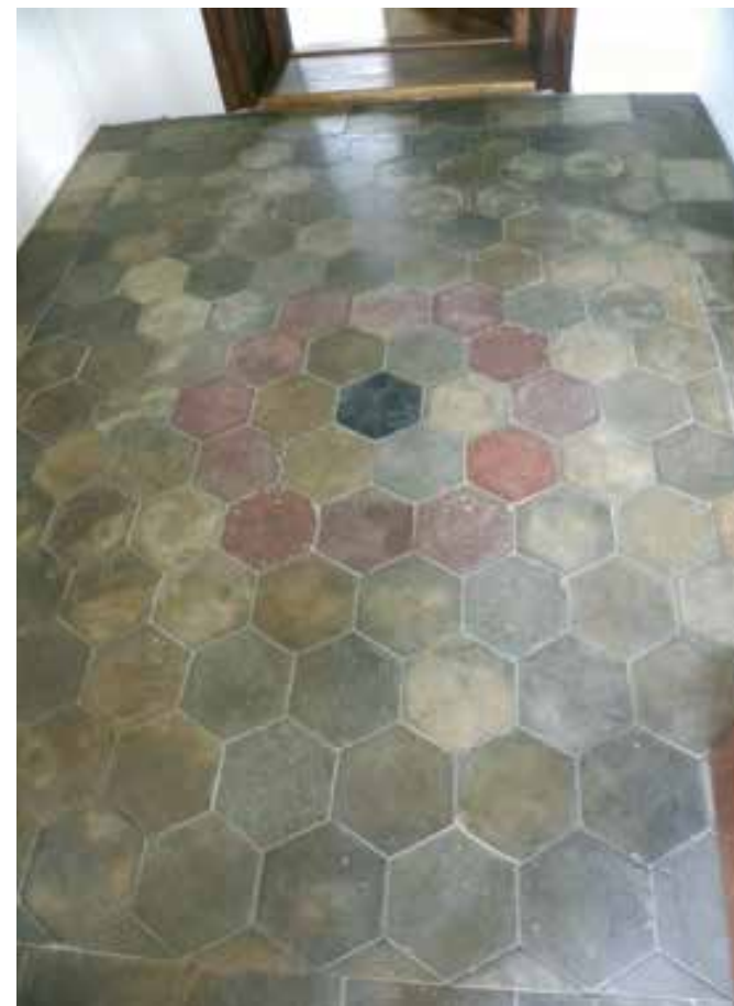
Kančevci, stara šola, obnovljen betonski tlak v veži, april 2020 (foto: S. Vešligaj)
