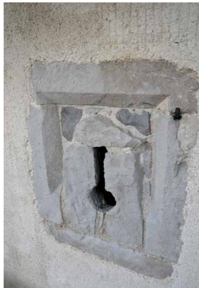
Planina, zvonik cerkve sv. Marjete, gotsko okno s sekundarno vzdano strelnico v tretjem nadstropju severne fasade (foto: M. Osojnik)
