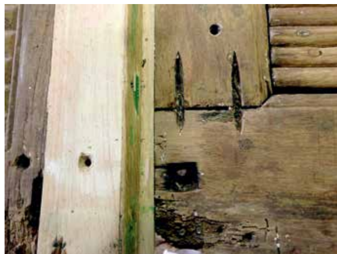
Domačija Matavun 8; akrilne plombe so odstopale in povzročale poškodbe (foto: Damijan Koradin, 2018).
