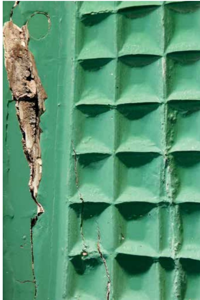
Domačija Matavun 8; po odstranitvi sekundarnih premazov so se razkrili kasnejši konstrukcijski posegi (foto: Damijan Koradin, 2018).
