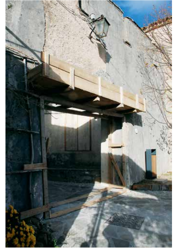
Šmartno, severovzhodna vrata, potem ko je odpadel omet (foto: A. Ščukovt, 2017)
