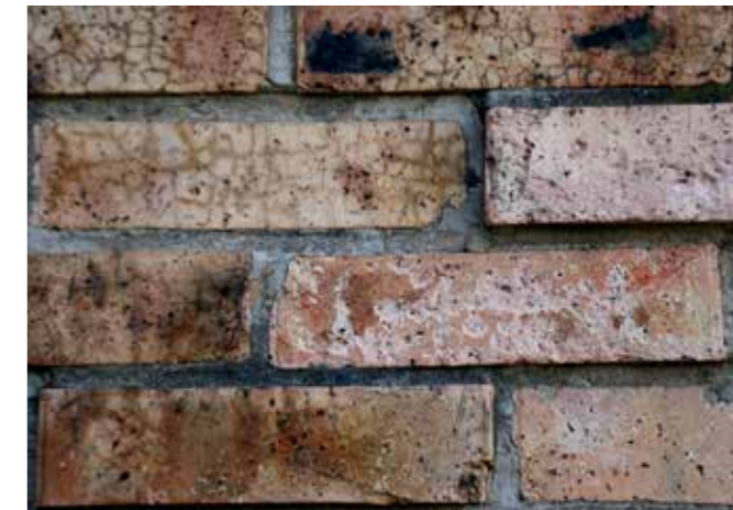
Ljubljana, soseska Ferantov vrt, značilne poškodbe fasadne opeke (foto: T. Adamič)
