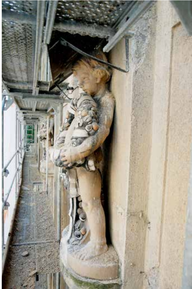
Ljubljana, Nemška hiša, kipi otrok z venci rož pred obnovo z že deformiranimi sekundarno dodanimi strešicami (foto: M. Režek Kambič, 2018)
