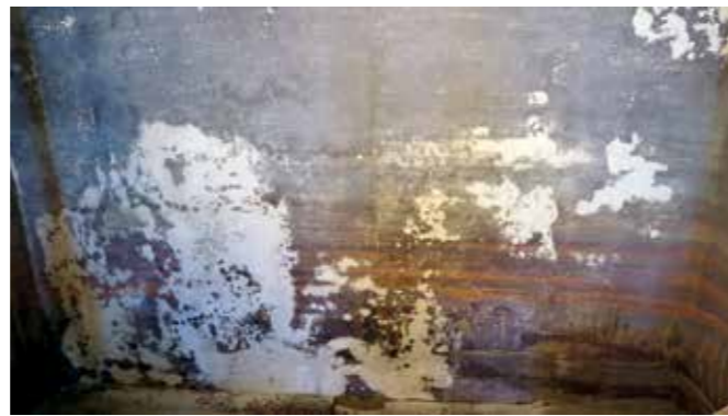
Vipavski Križ, cerkev sv. Križa, močno poškodovani del poslikave po končanem kitanju (foto: K. Zalar)
