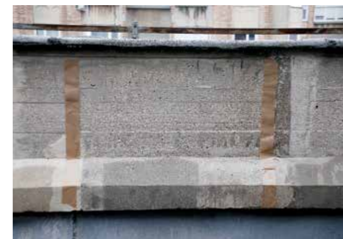
Ljubljana, soseska Ferantov vrt, blok B, vzorčno polje sanacije vidnega betona (foto: T. Adamič)
