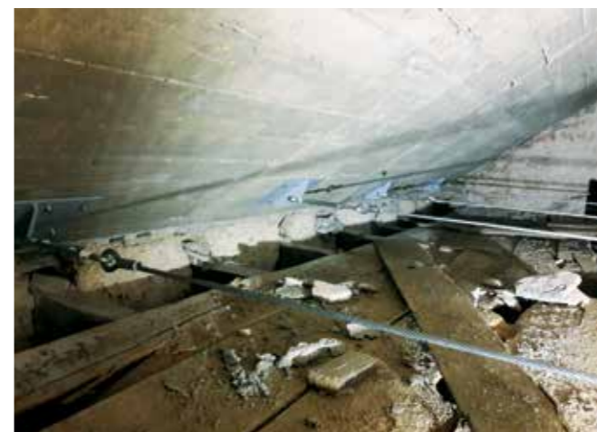
Gradišče pri Divači, cerkev sv. Helene, vgrajene prečne vezi na podstrešju cerkve (foto: A. Bratož)
