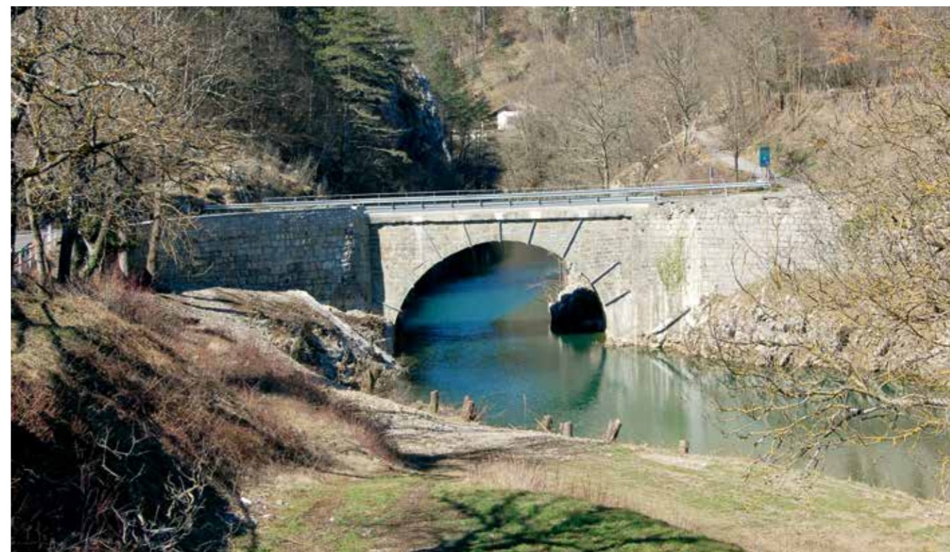
Škoflje, kamniti most čez Reko po izvedbi sanacijskih del v letu 2018 (foto: Eda Belingar, 2019)
