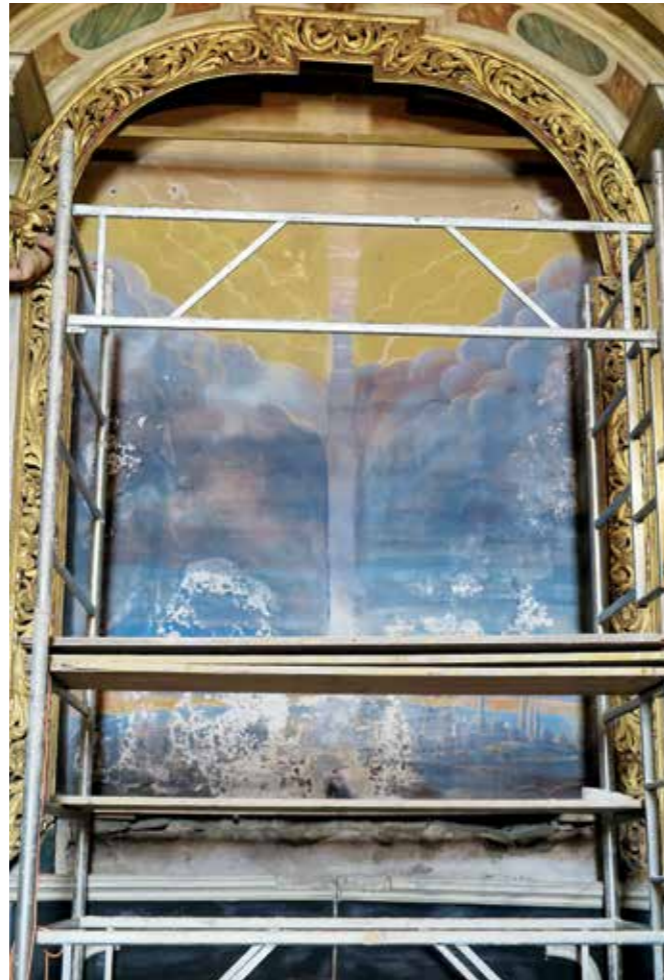
Vipavski Križ, cerkev sv. Križa, poslikava pred posegom in po odstranitvi Križanega (foto: K. Zalar)
