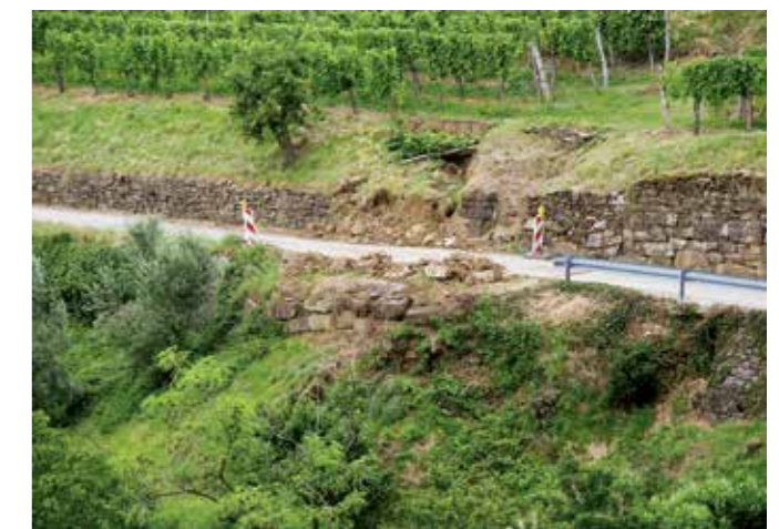
Gradno, stanje kamnitega zida po ujmi (foto: A. Ščukovt, 2017)
