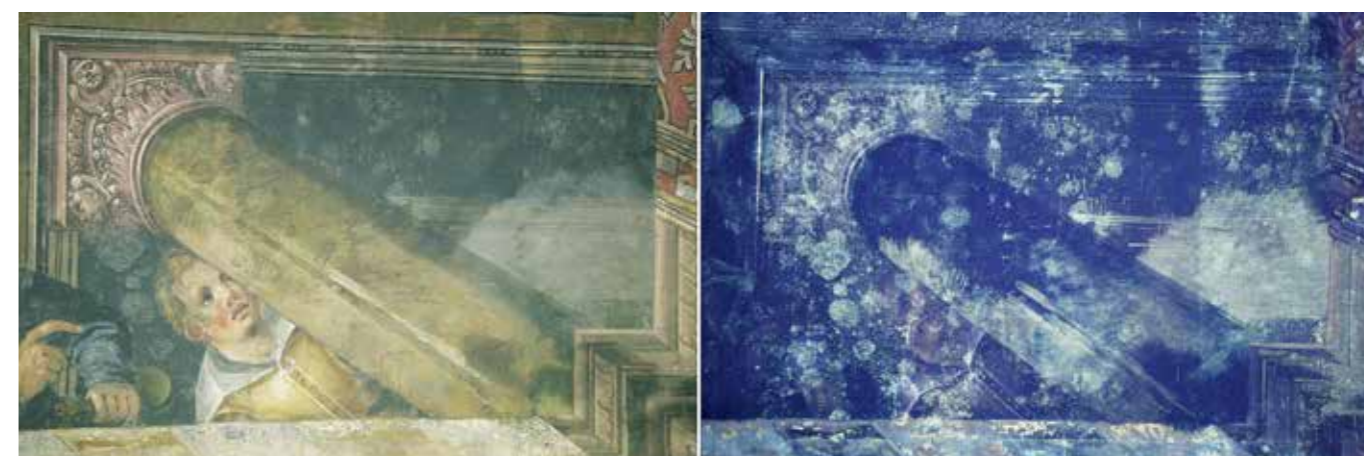
Celje, Celjski strop, detajl osrednjega prizora v vidni (levo) in ultravijolični (UV) svetlobi (desno). Nad dečkovo glavo in ob stebri so plesnivi madeži vidni že v vidni svetlobi, medtem ko jih na stebri in njegovem kapitelu opazimo šele v UV-svetlobi (foto: V. Benedik).
