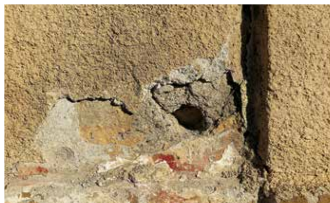
Ilirska Bistrica, Trg maršala Tita 6, posebno izrazite so bile poškodbe v pritličnem delu stavbe (foto: Klavdij Zalar, 2018).
