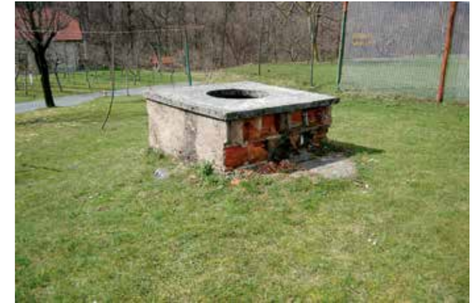
Orehek pri Postojni, zidani oklep štirne na šolskem vrtu je bil v razpadajočem stanju (foto: Eda Belingar, 2018)
