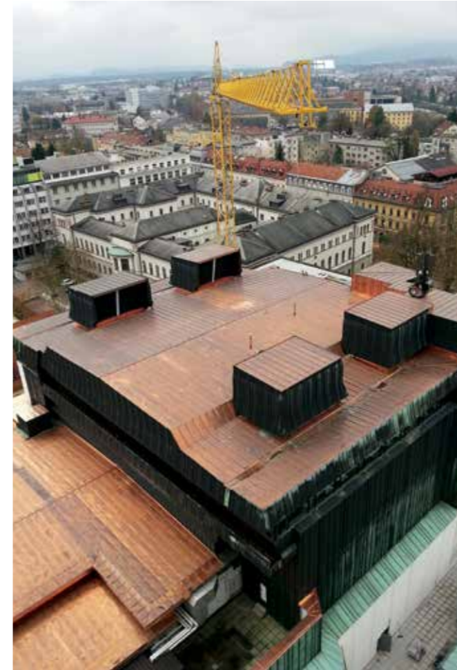
Ljubljana, Cankarjev dom, strehe, prekrite z novo bakreno pločevino (foto: V. Sever)
