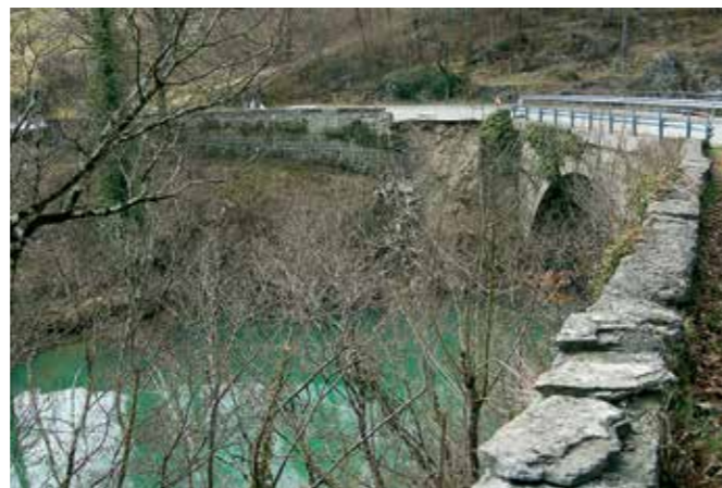
Škoflje, kamniti most čez Reko, v marcu 2018 se je porušil del krilnega zidu na levem bregu Reke (foto: Eda Belingar, 2018).
