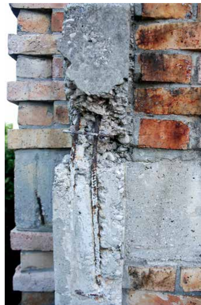
Ljubljana, soseska Ferantov vrt, odpadanje krovnih plasti betona in korozija armaturnih palic (foto: T. Adamič)
