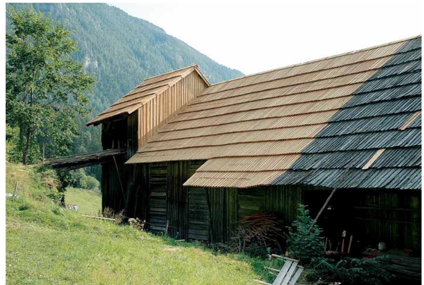
Podolševa 20, v celoti je bila strešna kritina zamenjana le na severozahodnem delu strešine, avgust 2018 (foto: B. Klanšek)
