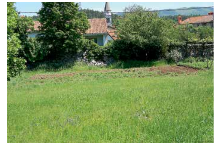
Divača, domačija Kraška 26, porušeni del zidu ob severovzhodnem robu posesti (foto: E. Belingar, 2017)
