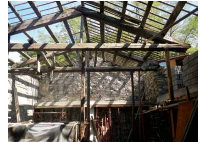
Lokavec, Bavčarjeva fužina, ojačitev deformirane zatrepne vkopane stene ob zajetju vode. Vidna sta sredinski steber in prva prečna ojačitev z AB-nosilcem (foto: B. Zbačnik).
