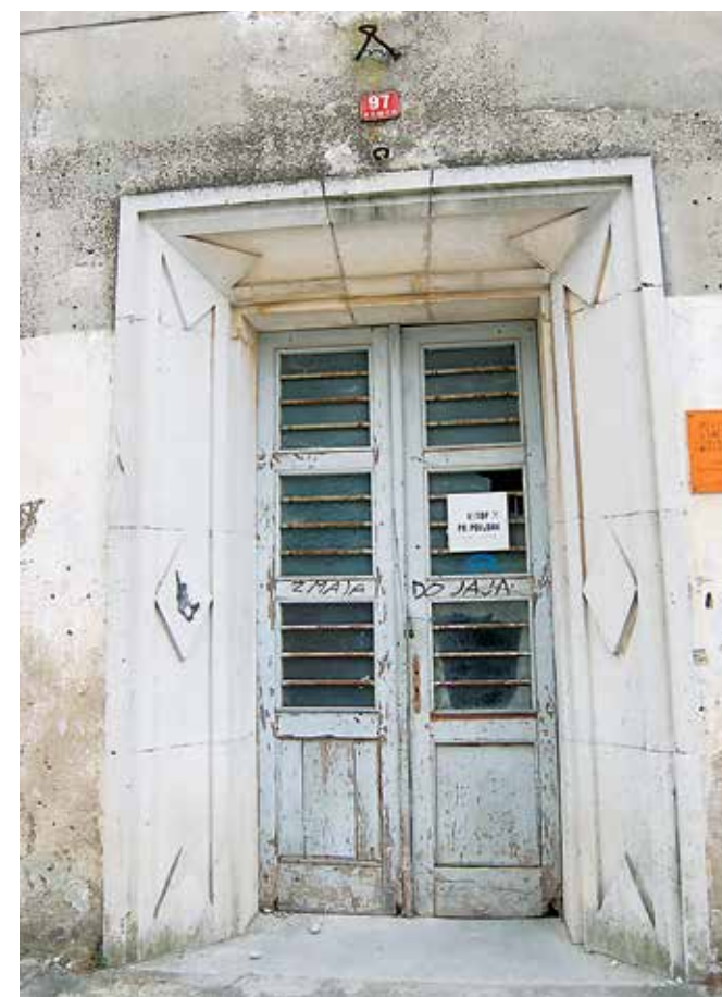
Komen, z monumentalnim kamnitim portalom opremljena vhodna odprtina šole (foto: E. Belingar, 2017)
