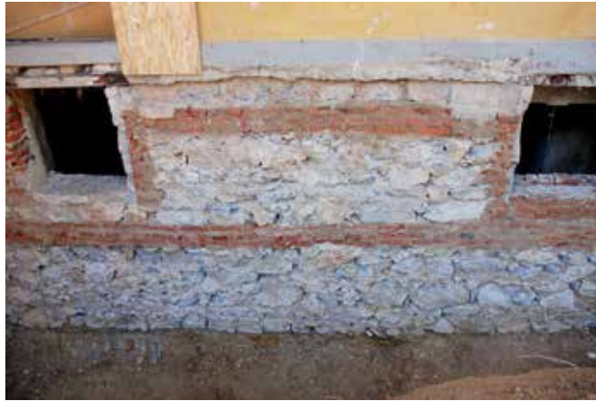
Ljubljana, nekdanji hotel Tivoli, t. i. Švicarija, temeljni zid na vzhodni strani objekta pred izvedbo hidroizolacije (foto: T. Adamič)
