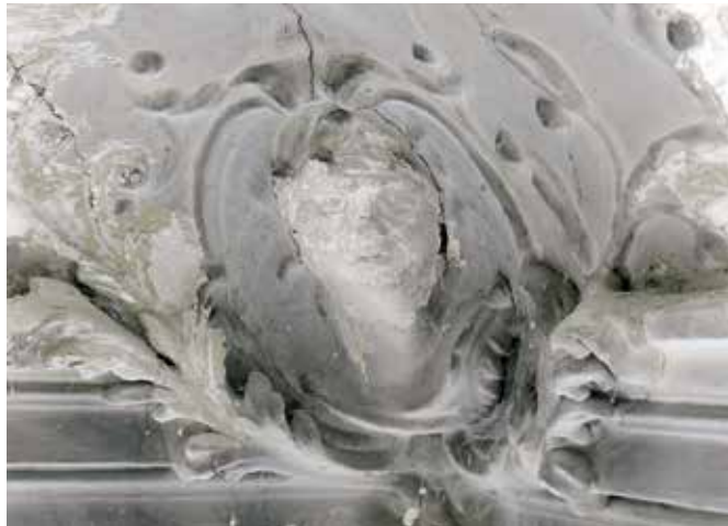
Ljubljana, gostilna pri Vitezu, detajl ženske glave med odkrivanjem. Vidne so poškodbe po vsej površini (foto: A. Šiles, 2017).
