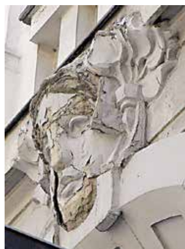
Ljubljana, Obrtna šola na Aškerčevi cesti, glava nad vhodom pred posegom (foto: arhiv ZVKDS, RC)
