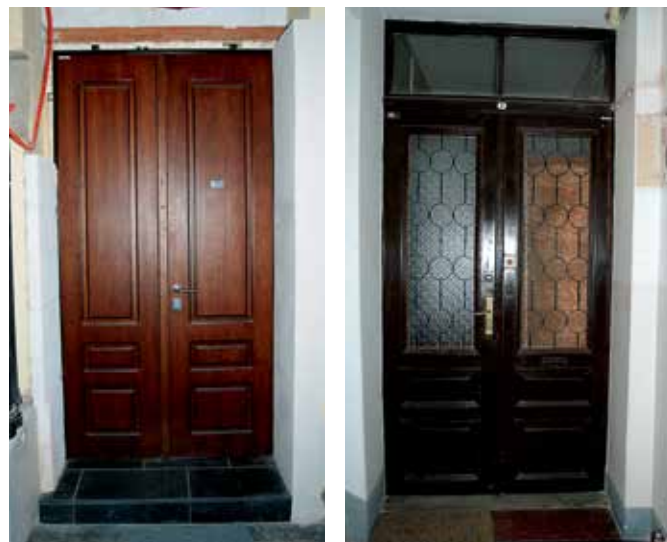
Ljubljana, hiša Prešernova cesta 16, neustrezna vrata v stanovanje – levo; prvotna vrata v stanovanje – desno (foto: M. Režek Kambič, 2016)
