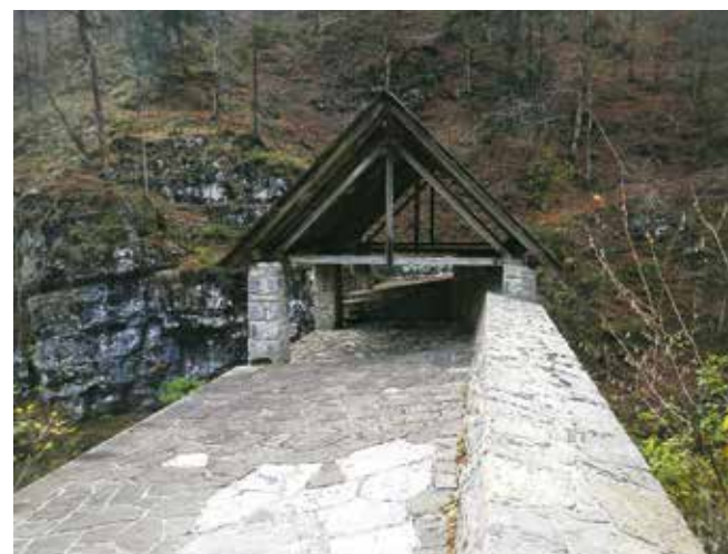
Idrijska Bela, Belčne klavže, streha pred prenovom (foto: B. Zbačnik)
