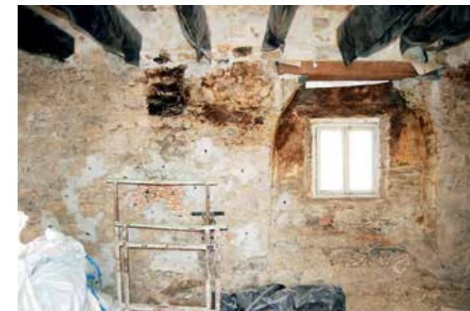
Domačija Šmarje 2; po odstranitvi ometov so se v kuhinji pokazali zazidana dimniška odprtina in ostanki krušne peči (foto: E. Belingar, 2017).
