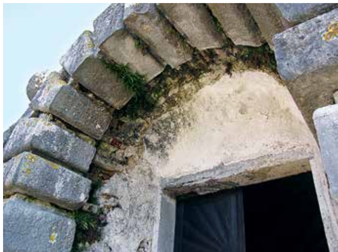
Soteska, Hudičev turn, preperel material in globoke poškodbe obočnega ostenja (foto: K. Rus)
