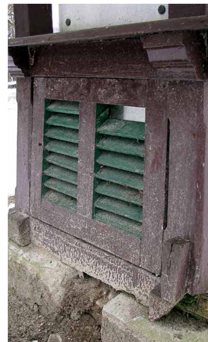
Bled, vremenska hišica s spominsko ploščo Arnoldu Rikliju, detajl poškodb baze vremenske hišice (foto: R. Pamič, 2016)
