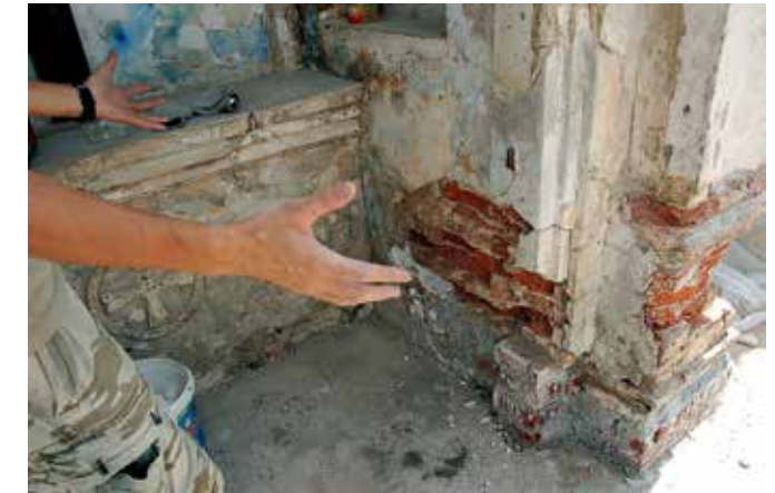
Planina, kapelica v Dolnji Planini, restavratorska dela na kapelici so se pričela julija 2017. Opečni zidaki kapelice so bili vključno z ometom v razpadajočem stanju (foto: E. Belingar, 2017).
