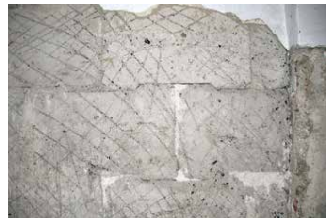
Ljubljana, nekdanji hotel Tivoli, t. i. Švicarija, stena hodnika v prvem nadstropju, zidana z zidaki iz mavčnega veziva in lahkega poroznega agregata, ki spominja na ogorke iz kurišč (foto: T. Adamič)
