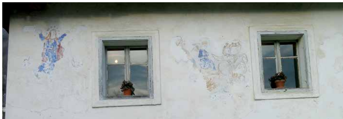
Peče, zahodna fasada Mejnikove hiše po pregledu ometov (foto: M. Tercelj Otorepec, 2016)
