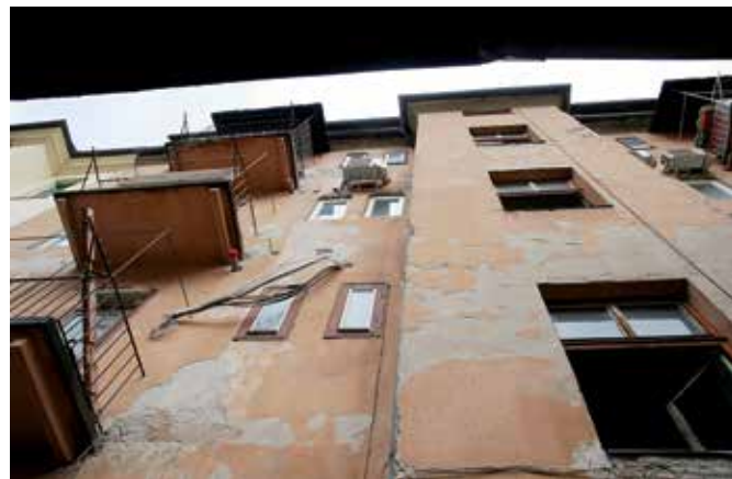
Ljubljana, hiša Prešernova cesta 16, dvorišna fasada pred obnovo (M. Režek Kambič, 2014)
