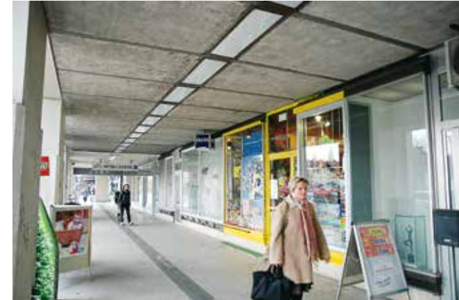
Ljubljana, del arkadnega hodnika Slovenska cesta 15 pred prenovo (foto: M. Režek Kambič, 2010)
