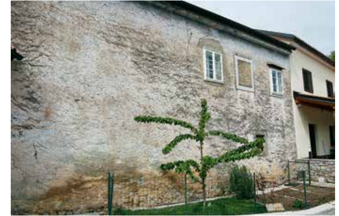
Matavun, jugovzhodna fasada stare hiše z nameščenimi novimi zunanji okenski krili (foto: E. Belingar, 2017)
