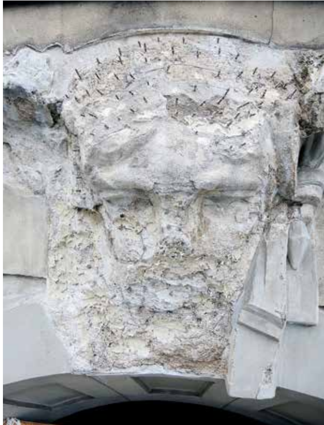
Ljubljana, Obrtna šola na Aškerčevi cesti, kovinska armatura za boljši oprijem nadomestne malte (foto: arhiv ZVKDS, RC)
