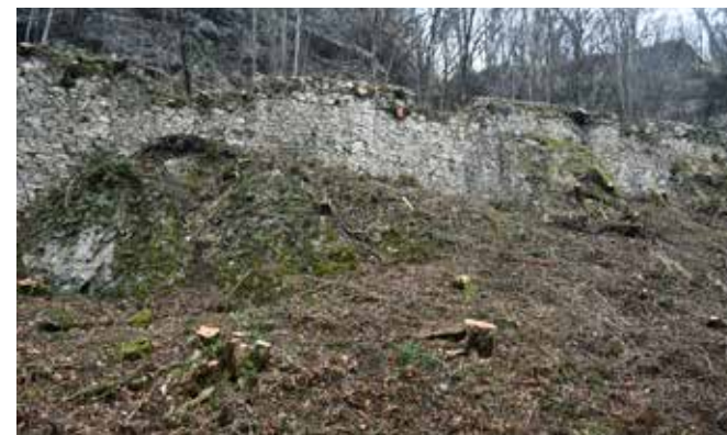
Sela pri Volčah, podporni zid stare soške poti pred sanacijo (foto: A. Ščukovt, 2017)
