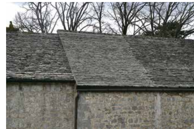
Dolenja vas pri Senožecah, cerkev Žalostne Matere Božje, obnovljena streha (foto: Minka Osojnik)
