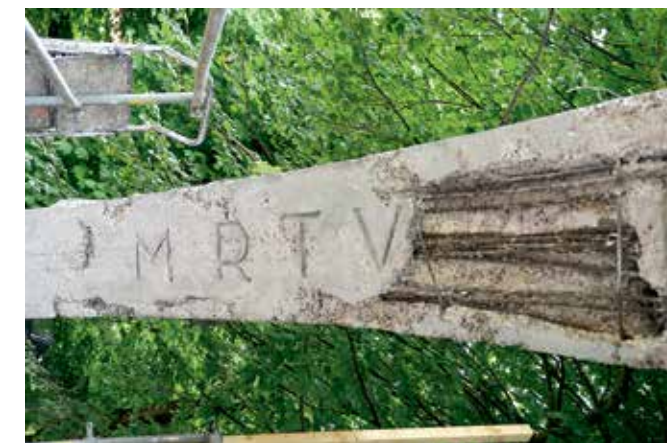
Kamnik, spomenik padlim v prvi svetovni vojni na Žalah, korozija betona in armature na slavaloku (foto: R. Pamič, 2017)
