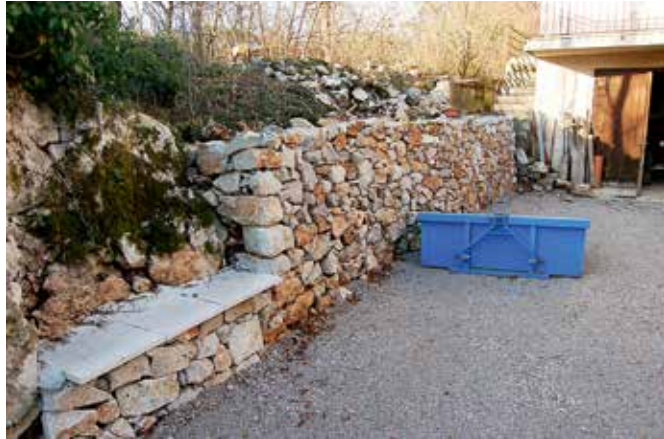
Mejni zid hiše Matavun 3b je bil skoraj v celoti porušen. Predhodno je bil ob dovozu do hiše izveden podporni zid (foto: E. Belingar, 2016).
