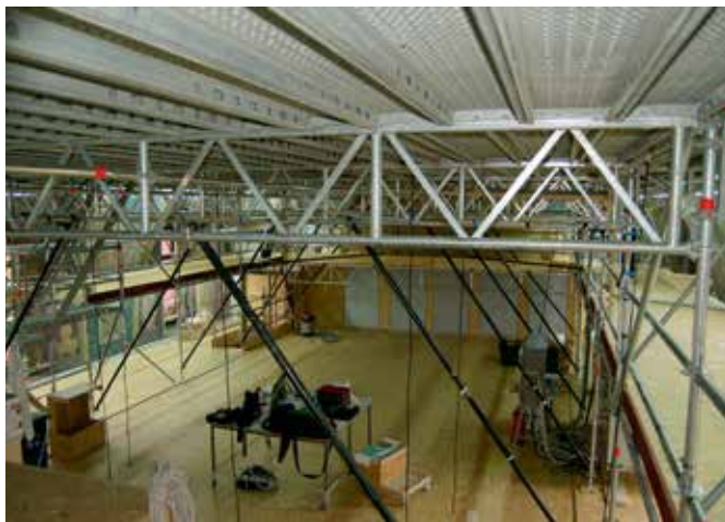
Ljubljana, cerkev Marijinega oznanjenja, odrska konstrukcija s sistemom prezračevanja ter sistemom meritev temperature in relativne vlage (foto: M. Lesar Kikelj, arhiv RC ZVKDS)
