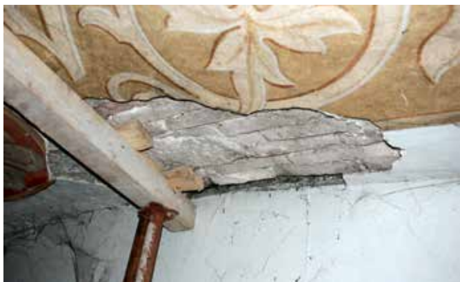
Novo mesto, cerkev sv. Lenarta, poškodbe ometov na obokanem stropu, detajl (foto: T. Mesojedec)
