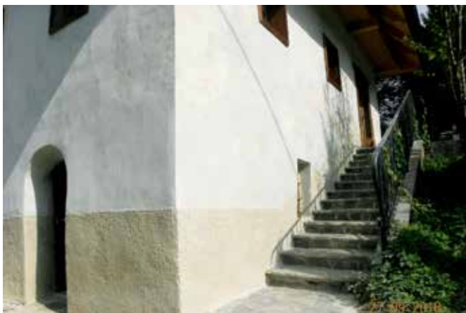
Podgora pri Hotavljah, hiša Podgora 11, rekonstruiran cokol in fasade, pripravljene za apneni oplesek (foto: D. Pediček, 2016)
