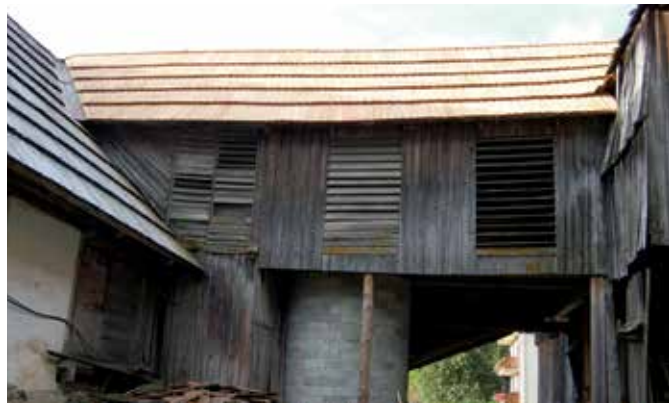
Podolševa, gospodarsko poslopje domačije Podolševa 20, zamenjana strešna kritina na severni strešini južnega mostovža (foto: B. Klanšek)
