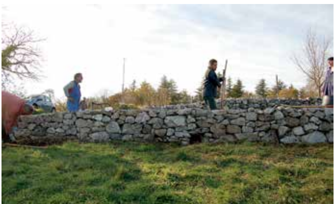
Škocjan pri Divači, ponovno pozidan del zidu z odprtino za odtok vode ob tleh (foto: E. Belingar, 2016)
