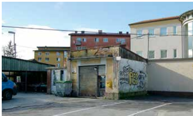
Ilirska Bistrica, pred obnovo je brivnica kazala žalostno podobo (foto: E. Belingar, 2012).
