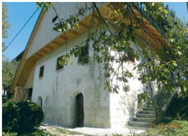
Podgora pri Hotavljah, hiša Podgora 11, injektirane razpoke in grobo pokrpan omet, pripravljen za nanos finega ometa (foto: D. Pediček, 2016)
