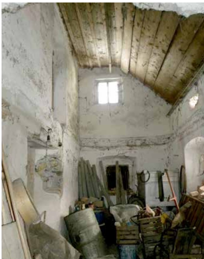
Brode v Poljanski dolini, domačija Brode 2, kamra s porušenim stropom pred obnovo (foto: D. Pediček, 2013)
