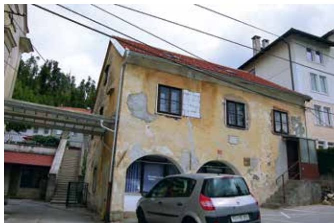
Postojna, stara bolnišnica pred izvedenimi deli (foto: E. Belingar, 2015)
