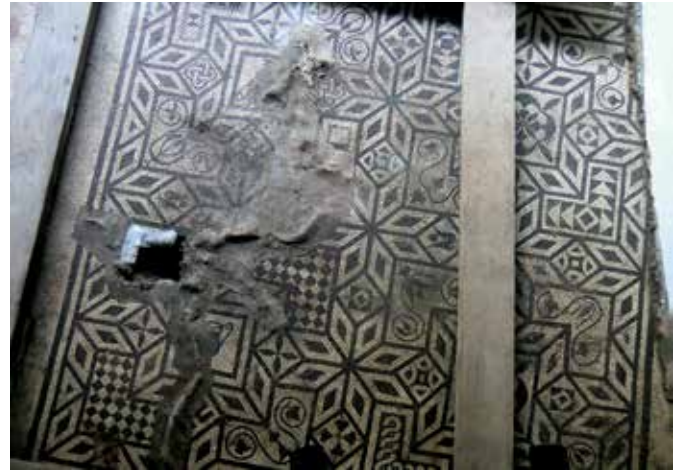
Celje, Glavni trg, črno-bel ornamentalni mozaik GT II/A po delnem odstranjevanju začasne zaščite, 2016. Vidni so dvigi in velika lakuna, ki je posledica drevesne korenine (foto: A. Mladenovič).
