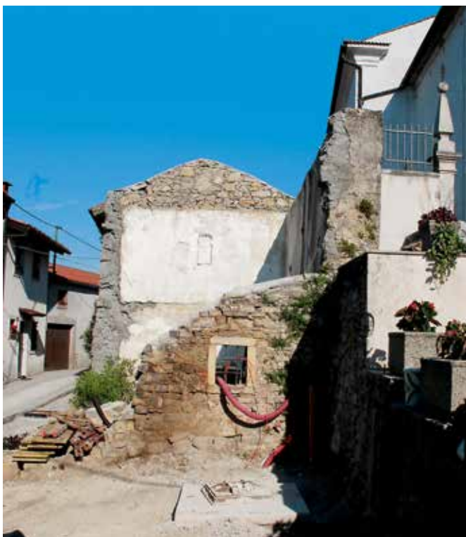
Vipavski Križ, ohranjen obodni zid hiše št. 32 po odločbi inšpektorja (foto: A. Ščukovt, 2015)
