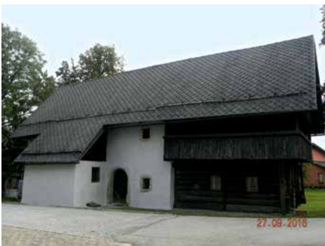
Dol pri Medvodah, Dolinčkova domačija, novi zaključni ometi in oplesk na vhodni fasadi (foto: D. Pediček, 2016)
