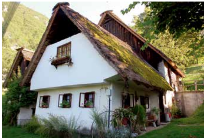
Dolenji Novaki, domačija Dolenji Novaki 5 pred zamenjavo slame na strešini glavne fasade (foto: A. Ščukovt, 2016)
