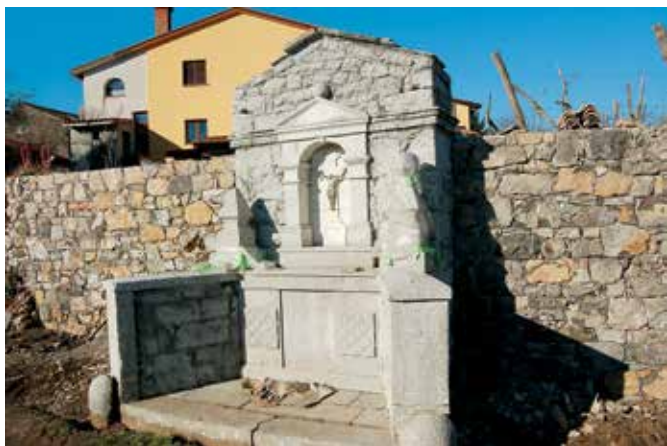
Kopriva; konec leta 2014 so domačini na novo pozidali podporni zid (foto: E. Belingar, 2014).
