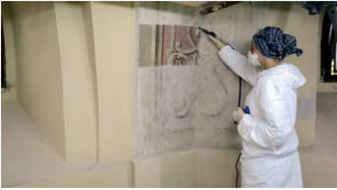
Škofja Loka, odstranjevanje zatrdelih beležev z minirotacijskimi brusilniki (Dremel) (foto: A. Kavčič Klančar, arhiv ZVKDS, RC)
