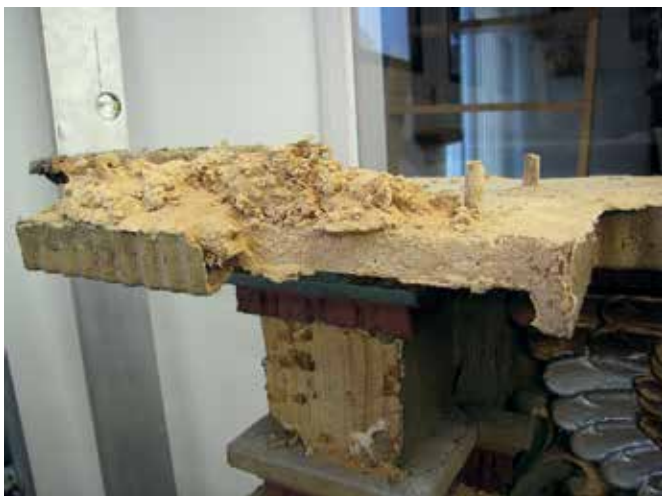
Četena Ravan, cerkev sv. Brikcija, glavni oltar, močno poškodovan leseni nosilec, posledica napada ksilofagnih insektov (foto: F. Kavčič)
