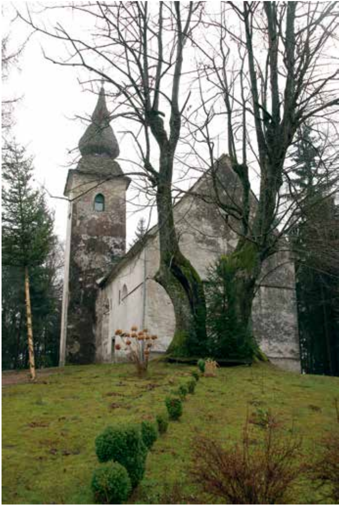
Spodnji Dolič, zunanja podoba propadajoče podružnične cerkve sv. Marjete pred obnovo (foto: U. Todosovska - Šmajdek, 2010, arhiv ZVKDS, OE Celje)
