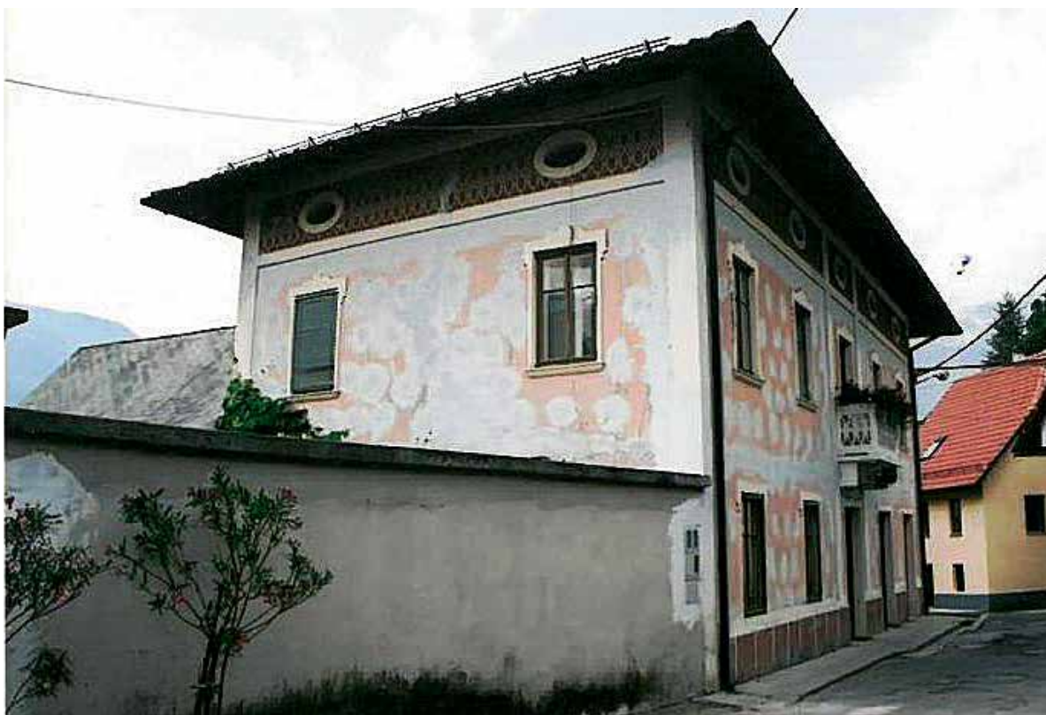
Bovec, Kot 55, pogled na objekt po prvi popotresni sanaciji, 2002 (foto: A. Ščukovt)
