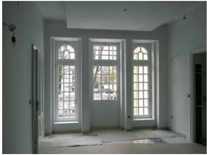
Ljubljana, vila Svetčeva ulica 4, pogled iz notranjosti na nova okna in vrata na terasi obcestne fasade v pritličju, 2012 (foto: I. Vesel)
