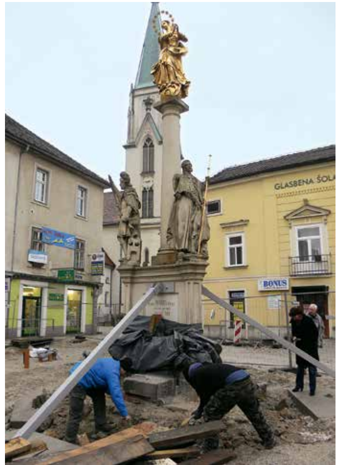
Celje, Marijino znamenje na Glavnem trgu med obnovo temelja in stopnic (foto: M. Krumpestar)
