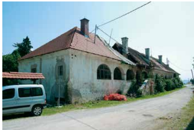
Slovenske Konjice, gospodarsko poslopje dvorca Trebnik, pogled na južno in zahodno fasado propadajočega poslopja (foto: U. Todosovska - Šmajdek, 2011, arhiv ZVKDS, OE Celje)
