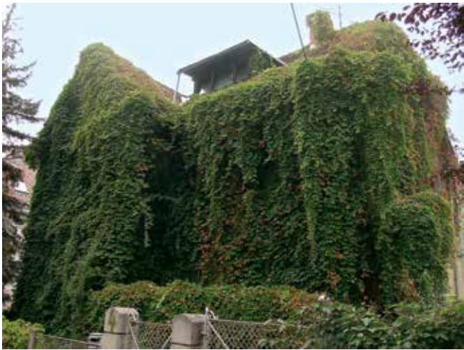
Ljubljana, vila Svetčeva ulica 4, zaraščena glavna ulična fasada, september 2005 (foto: I. Vesel)
