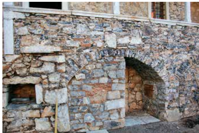
Tupelče, domačija Tupelče 4, s krušno pečjo zazidan obok zunanega zidanega stopnišča po odstranitvi ometov (foto: E. Belingar, 2015)
