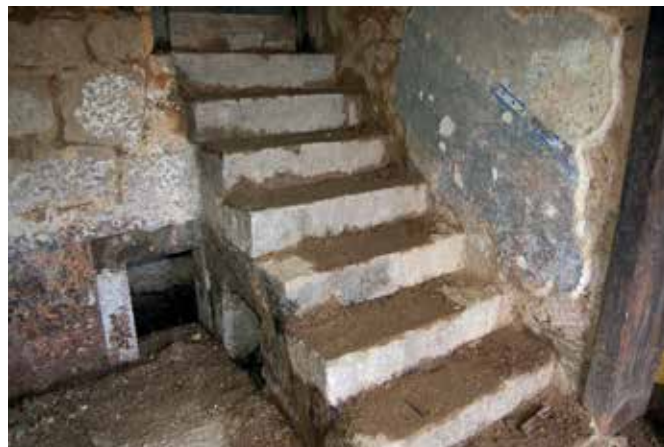
Kačiče, domačija Kačiče – Pared 13, notranje stopnišče s poslikavo sten pred obnovo (foto: E. Belingar, 2013)
