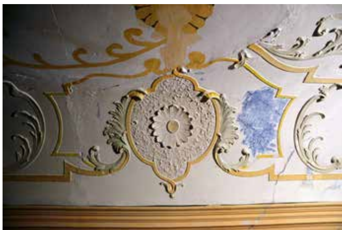
Vremski Britof, cerkev Marijinega vnebovzetja, sondiranje okoli poškodovanih štukatur na stropu (foto: M. Osojnik, 2013)
