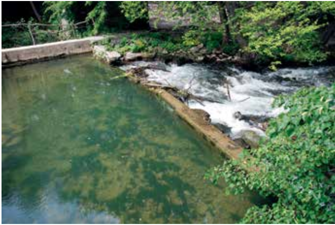
Škoflje, Dujčev mlin ob reki Reki, položno tlakovano dno od jezua proti strugi pred obnovo (foto: E. Belingar, 2013)
