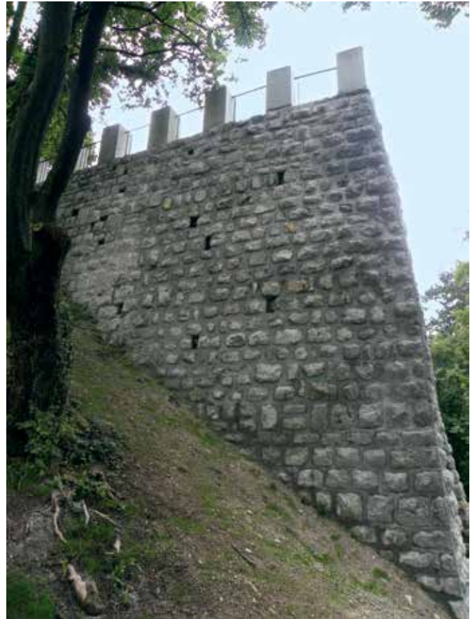
Ljubljana, parkovna ureditev grajske planote, saniran porušen del zidu, 2014 (foto: I. Vesel)
