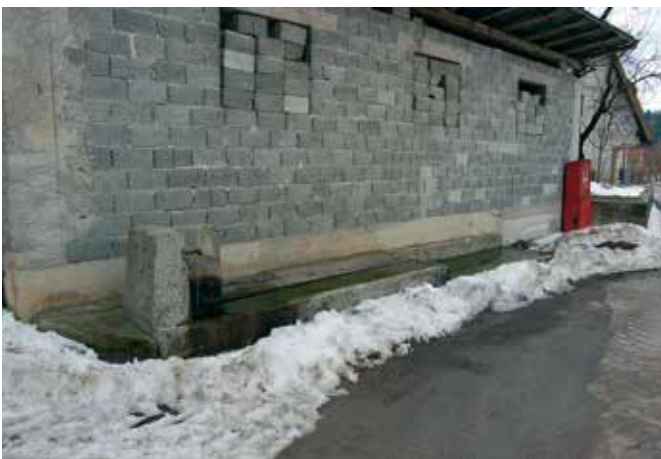
Belsko, Korito 2 pred obnovitvenimi posegi (foto: E. Belingar, 2010)
