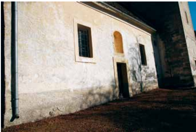
Hudinja, cerkev sv. Vida, pogled na južno fasado cerkvene ladje pred obnovо (foto: U. Todosovska - Šmajdek, 2012)
