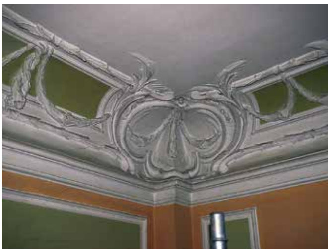
Ljubljana, Arhiv Slovenije, štukature v predsobi pred konservatorsko-restavratorskim posegom (foto: K. Zalar)
