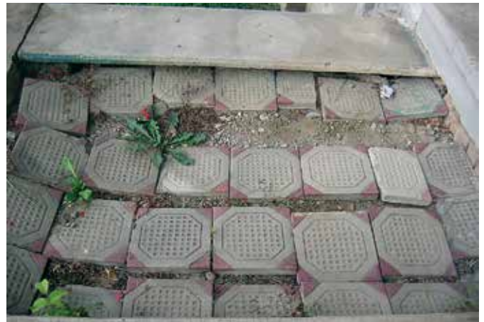
Lukavci, podest stebričastega stopnišča Muršičeve hiše pred obnovo (foto: S. Vešligaj, oktober 2008)
