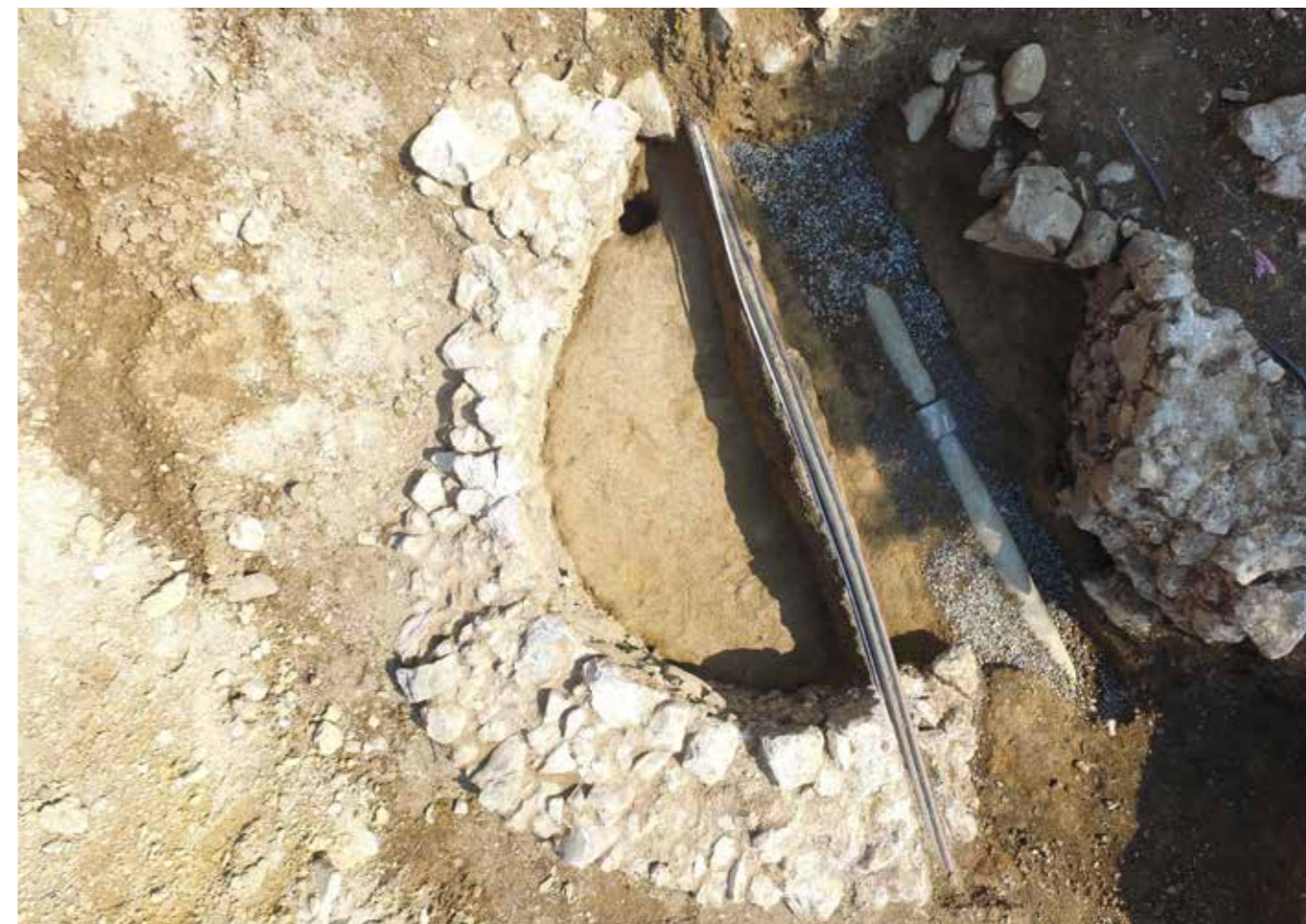
8a. Z infrastrukturnimi vodi poškodovan stolp (foto: K. Udovč, ZVKDS, CPA) 8a. Tower damaged by infrastructure cable conduits (photo: K. Udovč, ZVKDS, CPA)
