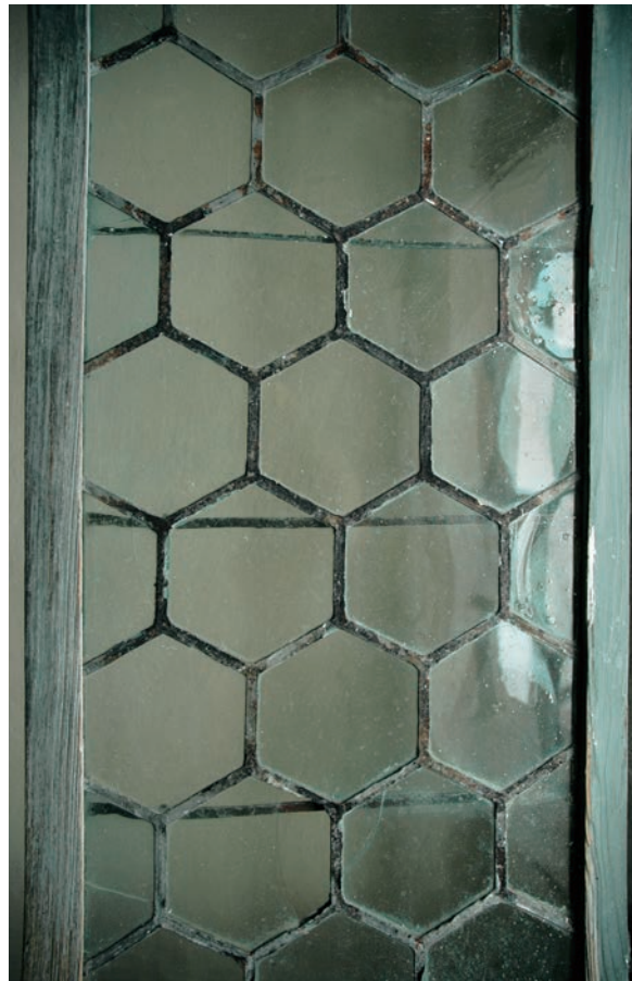
9. Detajl okenskega krila v zakristiji cerkve sv. Duha v Ribčevem Lazu v Bohinju iz okoli leta 1744 (foto: Robert Peskar)
