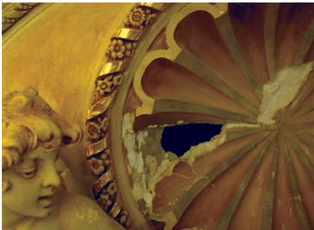
Ljubljana, Opera, poškodbe na štukaturnem okrasju, detajl proscenijske lože (foto: S. Dolinšek)
