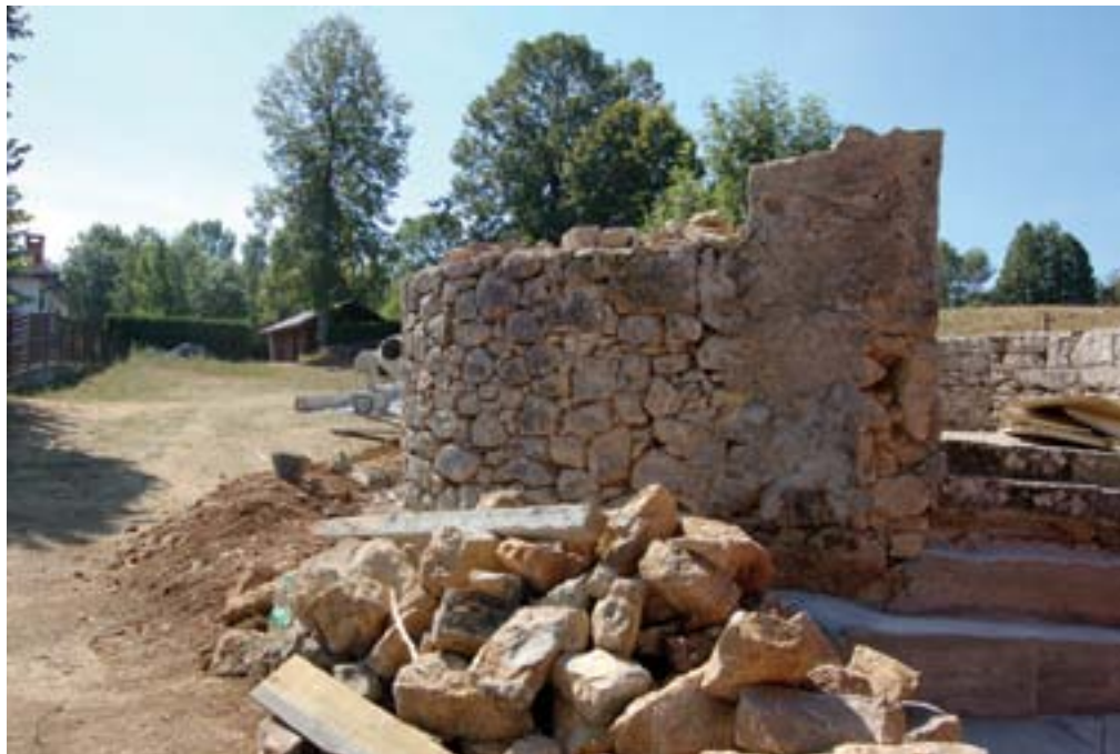
Klenik pri Pivki, struktura kamnitega obodnega zidu. Po odstranitvi ometa se je izkazalo, da je bil ta v preteklosti povišan (foto: E. Belingar, 2012).
