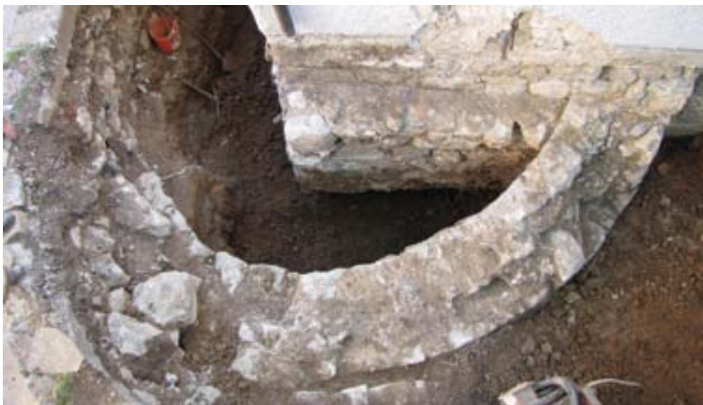
Dolenjske Toplice, tloris severnega dela stolpa protiturskega tabora, pogled proti jugu (foto: P. Peterle Udovič)
