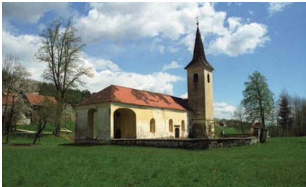
Podvrh, cerkev sv. Martina, stanje cerkve pred prenovno z vidnimi razpokami na južni fasadi (foto: A. Aškerc, 1999)
