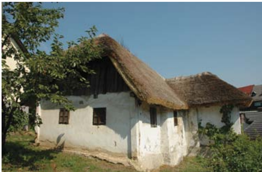
Metlika, hiša Bare Juričine, stanje po obnovi strehe (foto: D. Strgar)
