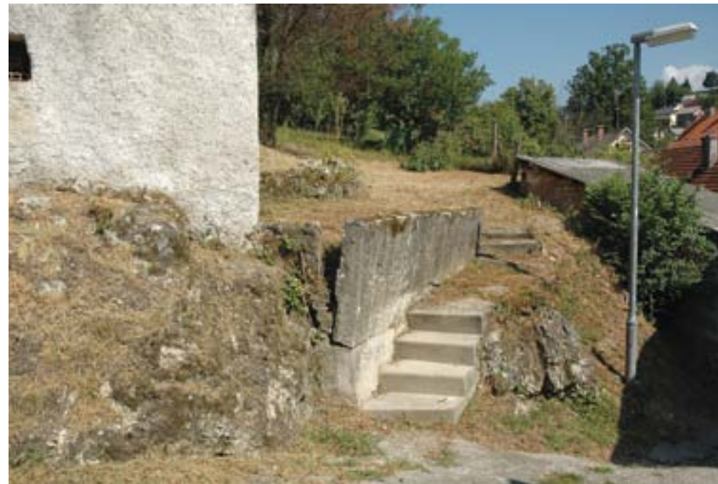
Metlika, hiša Bare Juričine, stanje opornih zidov pred obnovo (foto: D. Strgar)
