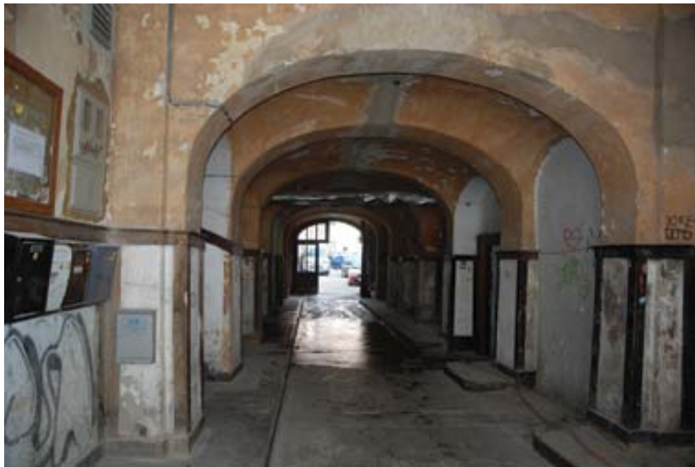
Ljubljana, hiša Trg francoske revolucije 4, pasaža pred obnovo (foto: M. Režek Kambič, 2012)
