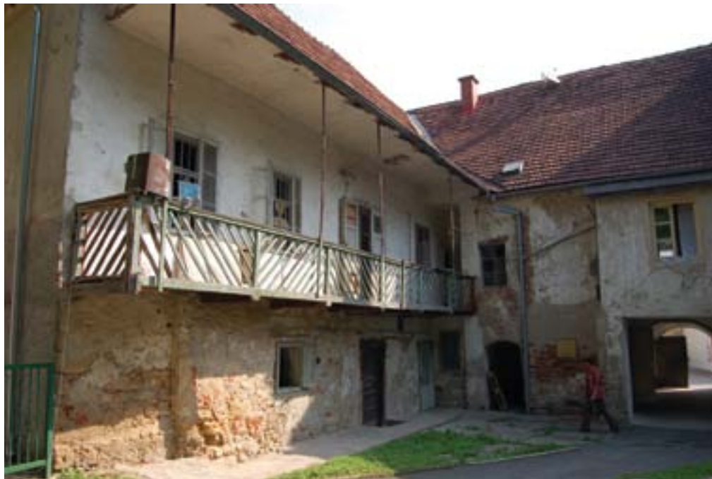
Gornja Radgona, hiša Jurkovičeva ulica 25, pogled na dvoriščno fasado pred obnovo (foto: N. Sulič Urek, 2008)
