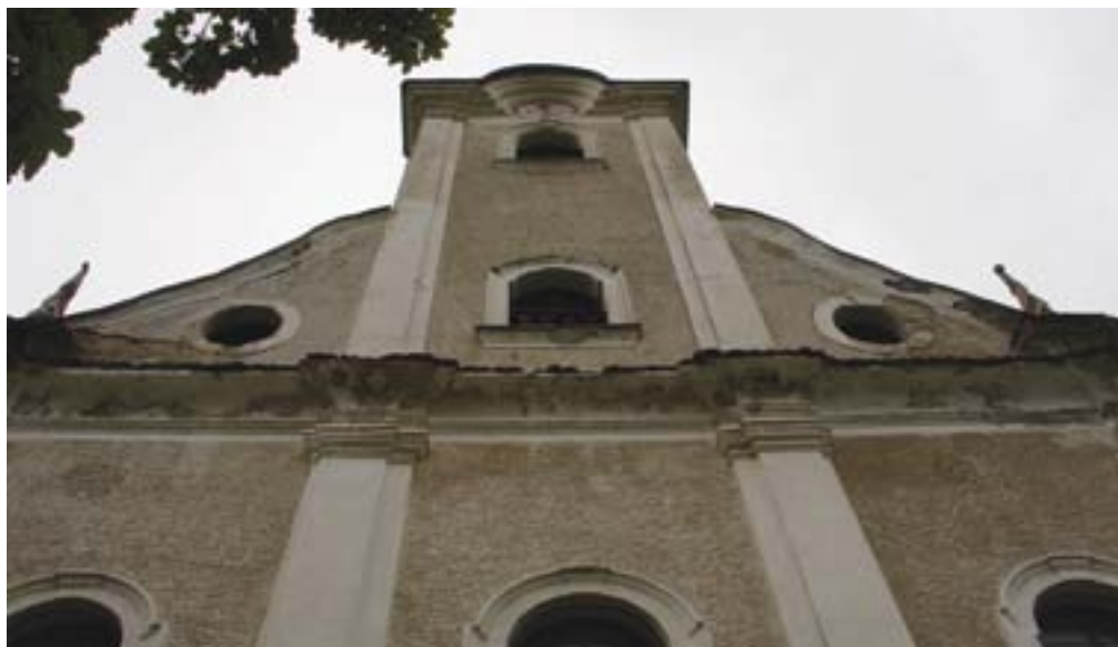
Vitanje, cerkev sv. Marije Pomočnice, poškodbe na čelni fasadi cerkve (foto: N. Podkrižnik, 2008)
