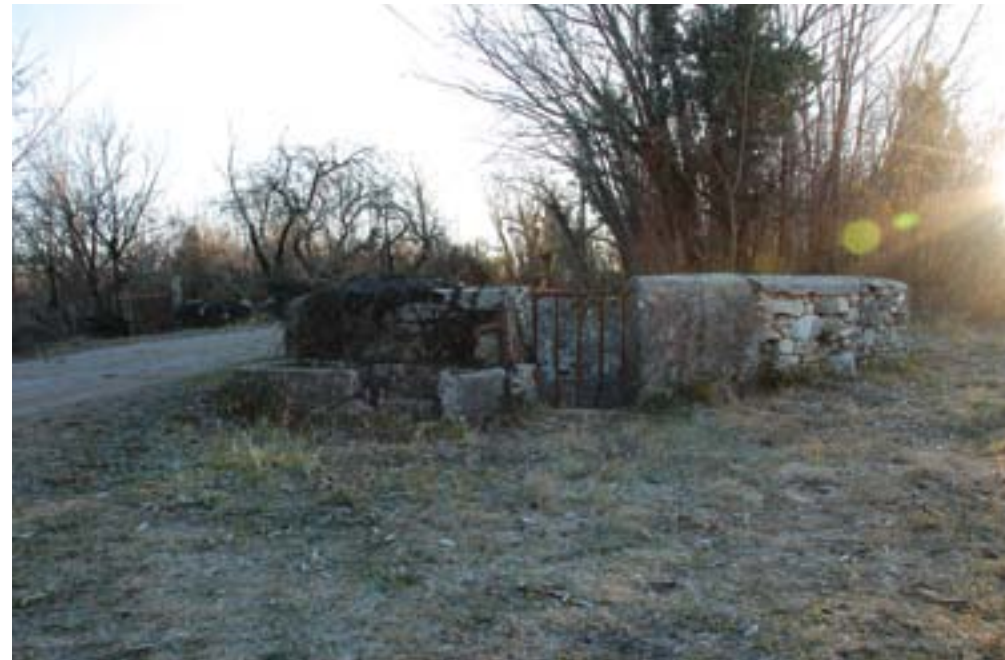
Korita na Krasu, vodni zbiralnik, stanje pred celovito obnovo (foto: A. Ščukovt, 2012)
