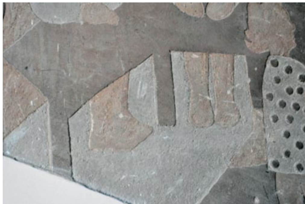
Ljubljana, Onkološki inštitut, stavba B, detajlni prikaz poškodb na prvem sgraffitu (foto: Tjaša Pristov, 2011)
