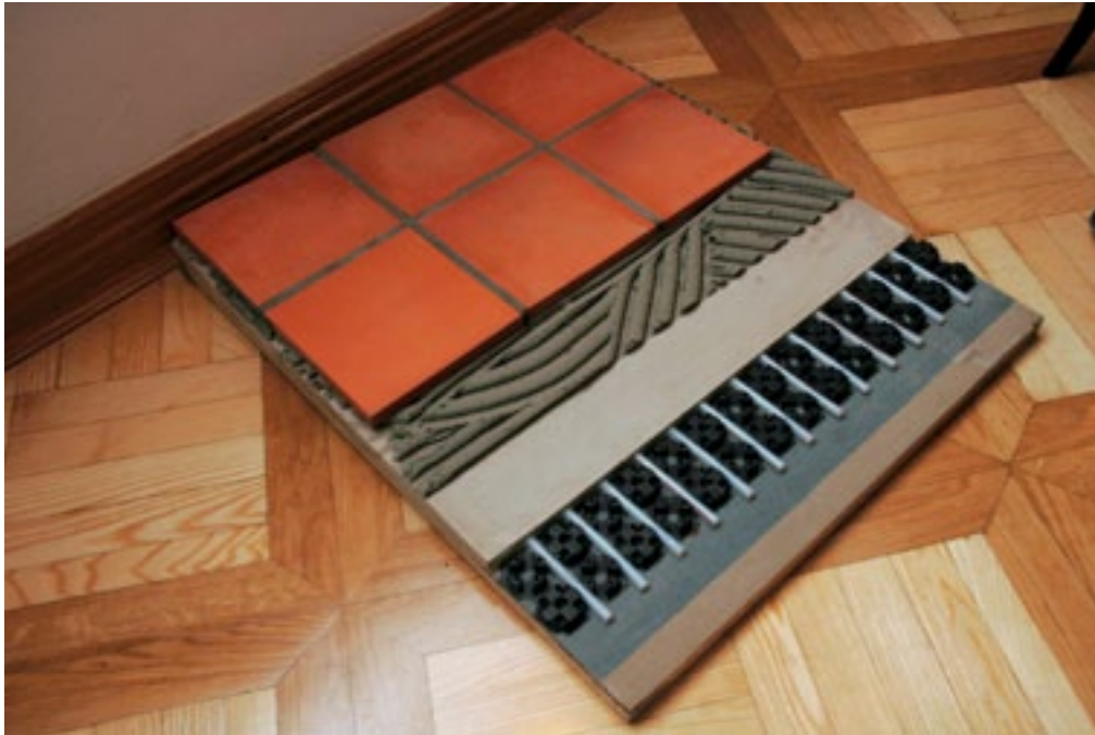
Grad Brežice, detajl toplovodnega talnega ogrevanja in opečnih tlakov iz viteške dvorane, skupne višine 4,5 cm (foto: T. Golob, 2011)
