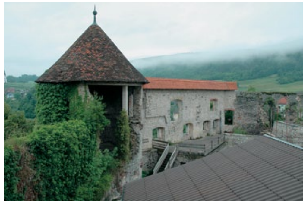
Grad Žužemberk, stanje stolpa št. 7 in z bršljanom zarasle stene »B« pred sanacijo (foto: T. Golob, 2007)
