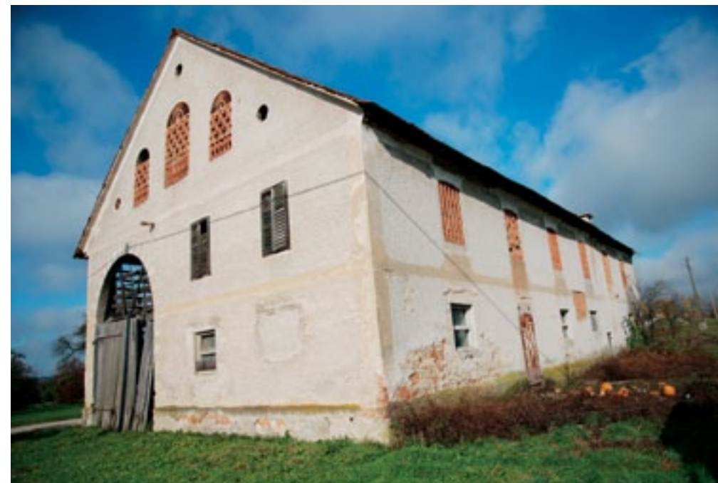
Leskovec 25 pred obnovo (foto: B. Hostnik)
