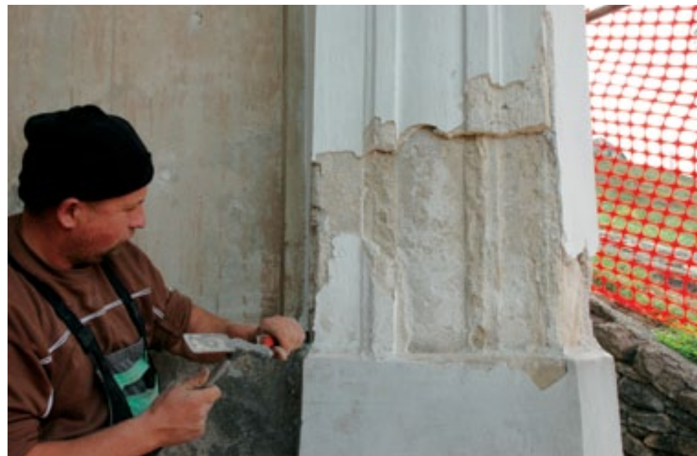
Predenca, kapelice križevega pota, odstranjevanje sekundarnih ometov (foto: B. Badovinac, 2010)
