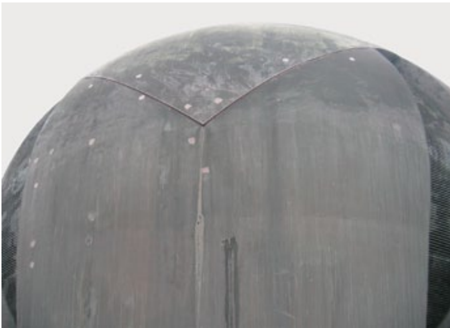
Maribor, spomenik NOB, površina spomenika pred obnovo, na kateri so vidni stiki, v katere je vpeta notranja konstrukcija spomenika (foto: D. Damjanović, november 2010)
