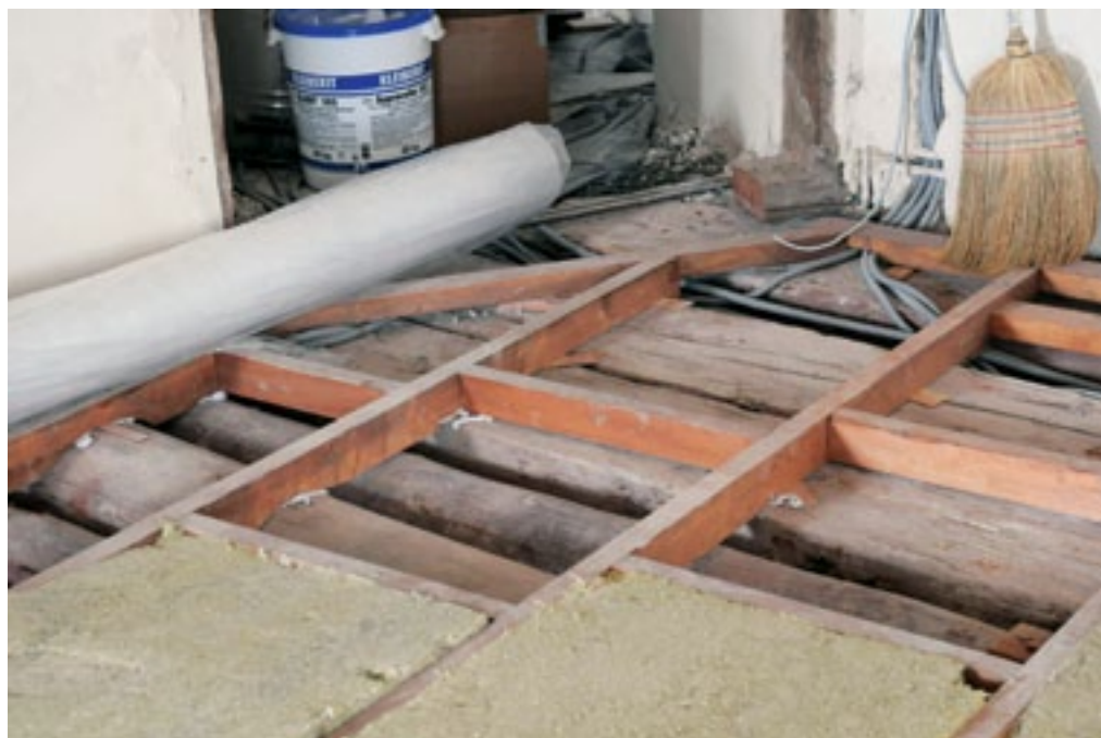
Grad Brežice, povezovanje lesenih stropnikov z izvedbo toplotne izolacije in vgradnjo inštalacij (foto: T. Golob, 2011)
