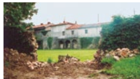
Ajdovščina, porušeni del zida v dolžini okrog 4 m (foto: A. Ščukovt, maj 2006)
