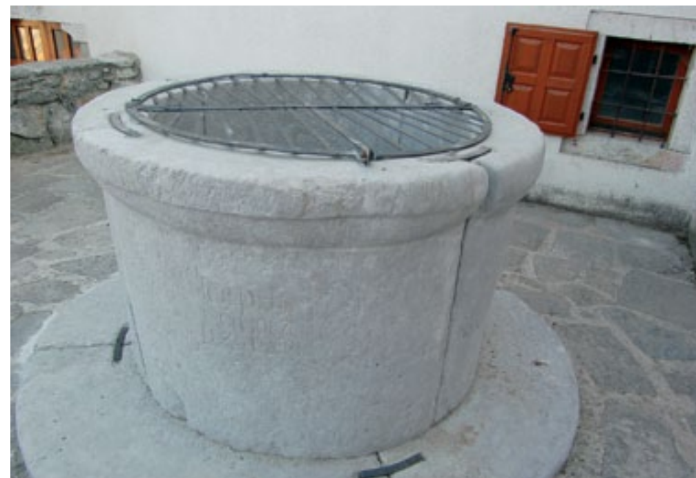
Naklo pri Divjači, vodnjak po izvedbi restavratorskih del in namestitvi prvotne kovane mreže (foto: E. Belingar, 2011)
