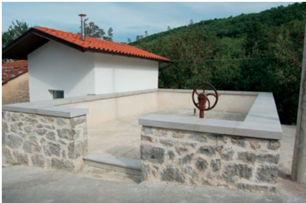
Dolenje pri Štjaku, manjkajoči deli ometa so dopolnjeni z ometi enake sestave in izvedbe kot prvotni, a žal nekvalitetno, nameščena sta kamnit zaključek vrh zidu in stopnica (foto E. Belingar, 2010).
