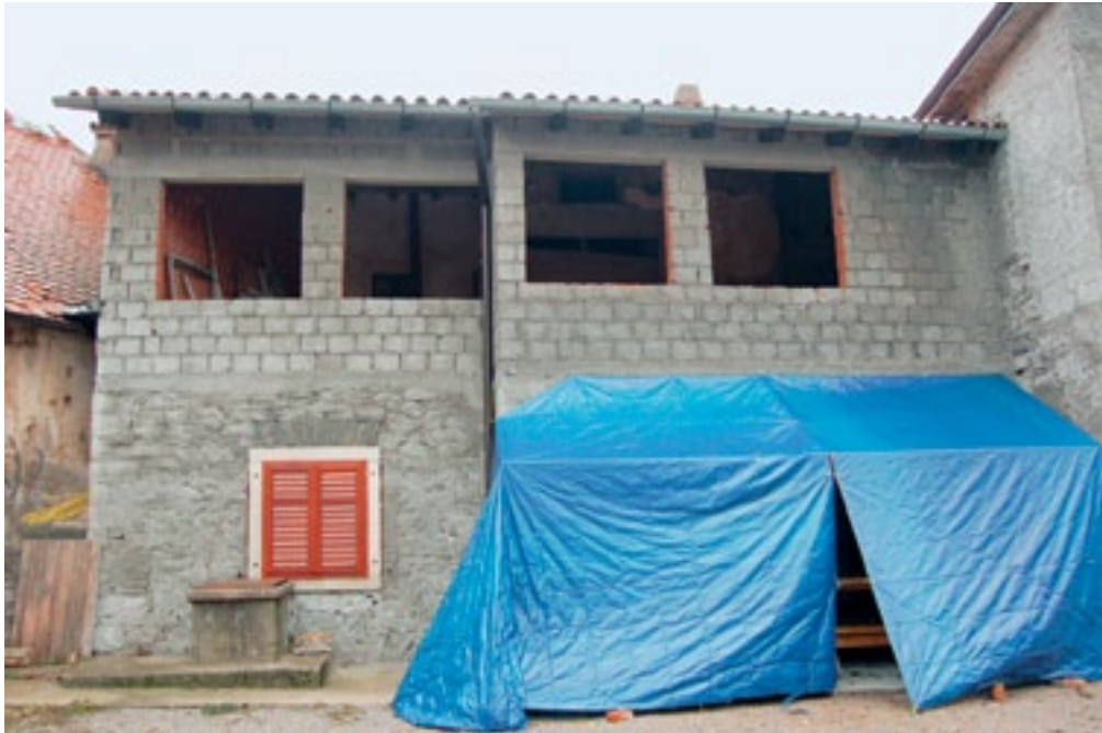
Dutovlje, dvoriščni del stanovanjske hiše Dutovlje 65. Nekaj let po drugi svetovni vojni je bila lastnica domačije Kmetijska zadruga, ki je začela določene posege na objektih, tudi prizidave, a jih ni dokončala (foto: E. Belingar, 2010).
