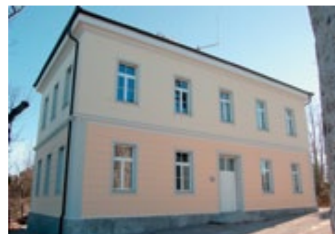
Tabor pri Vrabčah, manjkajoči deli ometa so dopolnjeni z ometi enake sestave in izvedbe kot prvobitni, nameščeno je stavbno pohištvo ter pobeljena fasada (foto: E. Belingar, 2011)
