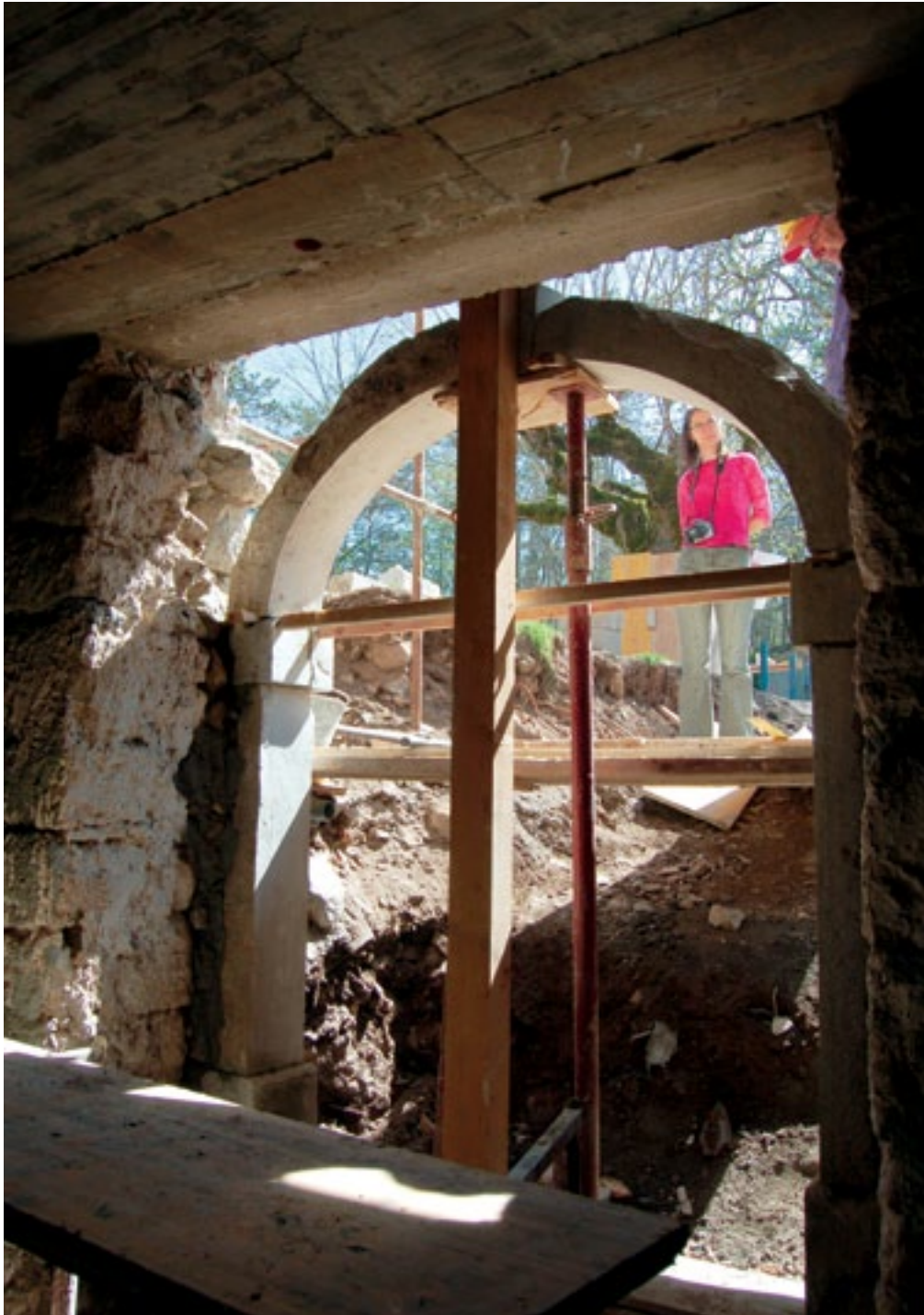
Domačija Matavun 8, montaža kamnitega vhodnega portala na svoje mesto v kleti (foto: E. Belingar, 2011)
