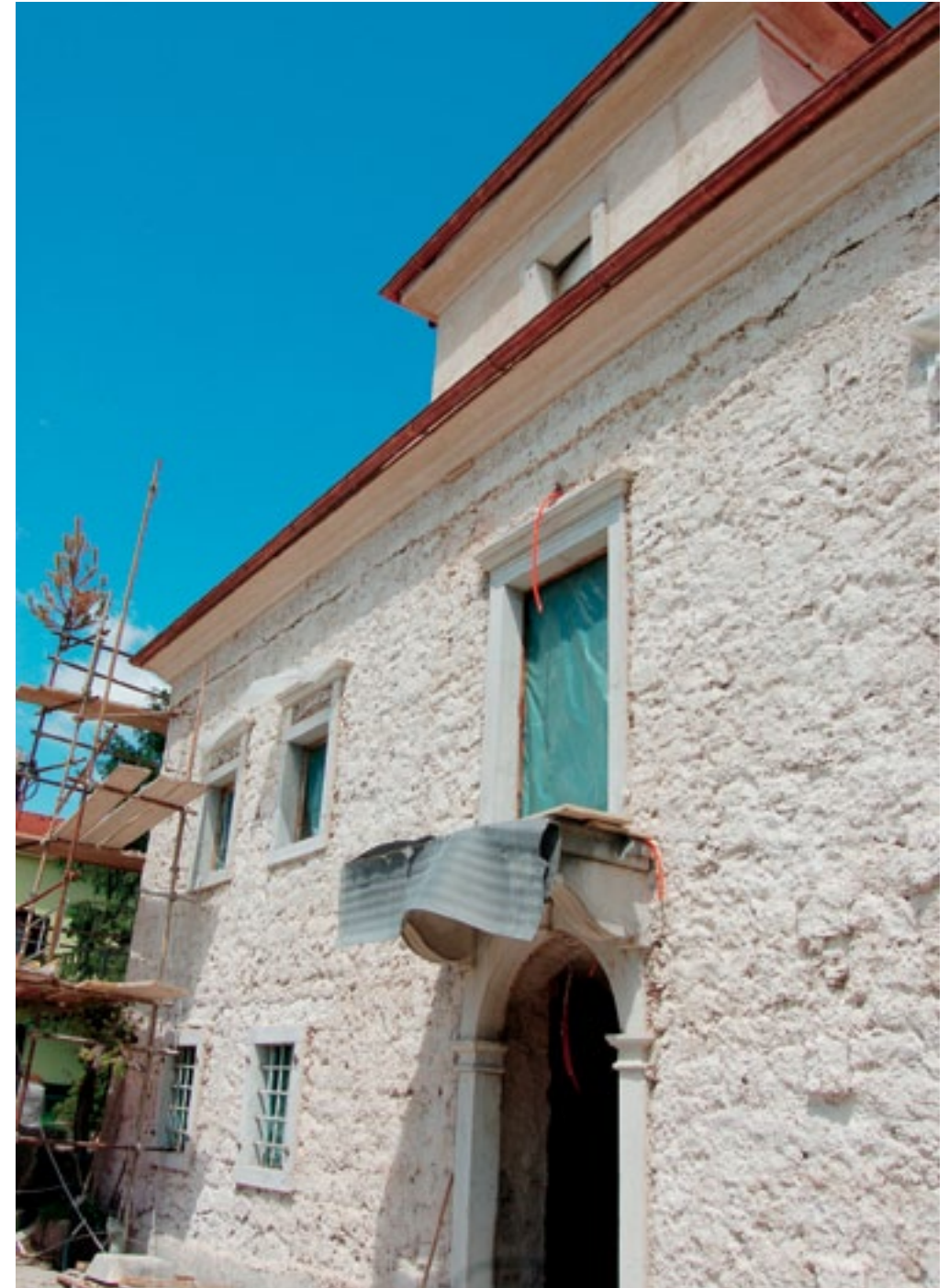
Domačija Matavun 8, vhodna fasada po nanosu grobega ometa in z izvedenim profiliranim strešnim vencem (foto: E. Belingar, 2011)
