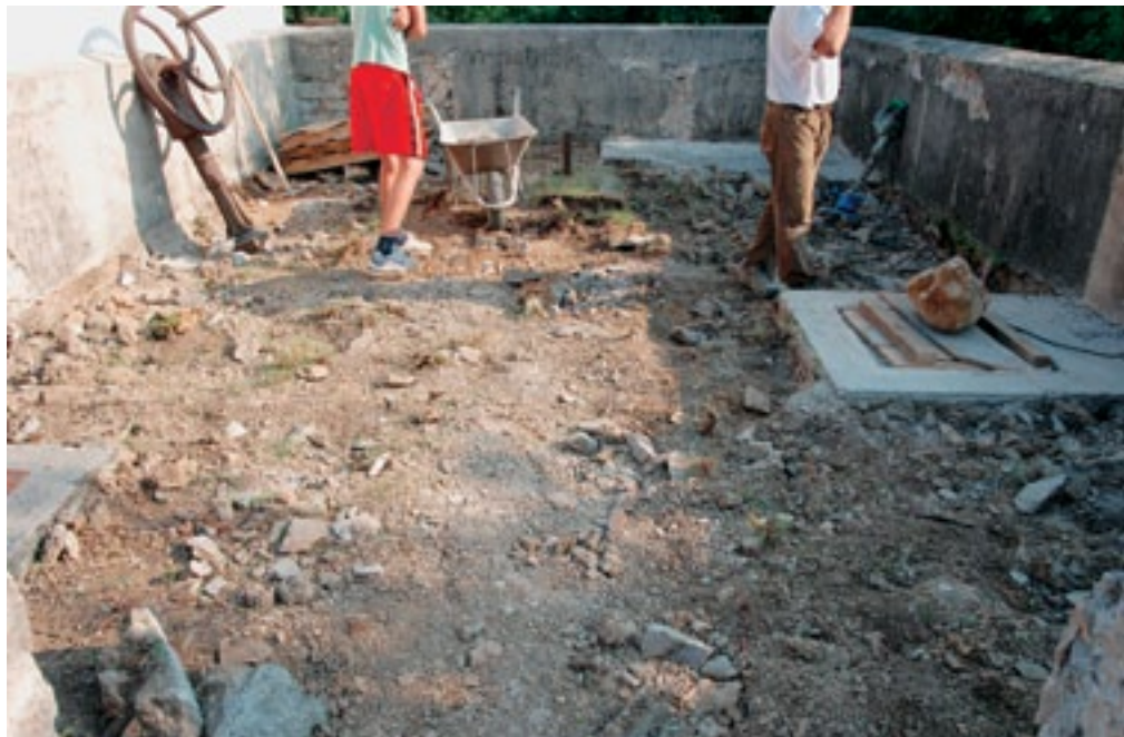
Dolenje pri Štjaku, po odstranitvi kamnitih skrli sta se razkrila vrh oboka podzemnega zbiralnika vode ter lep kamnit okvir vodnjaka, kjer so prvotno zajemali vodo (foto E. Belingar, 2010).
