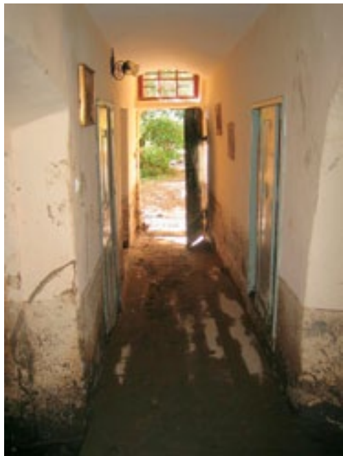
Železniki, Racovnik 9, poplavljena veža (foto: D. Pediček)
