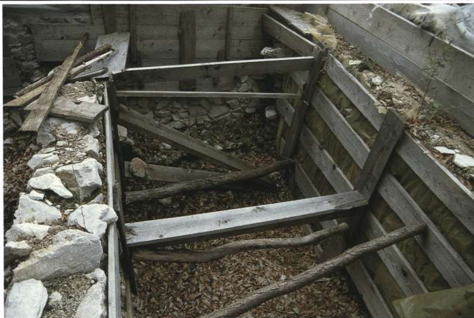
Zrušena in oprta južna stena cisterne, erodirani notranji temelji južnega zidu
