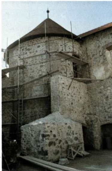
Obnova stolpa št. 4 leta 1999: pogled z grajskega dvorišča, dokumentacija Zavod za varstvo kulturne dediščine Slovenije, OE Novo mesto, foto: Tomaž Golob.
