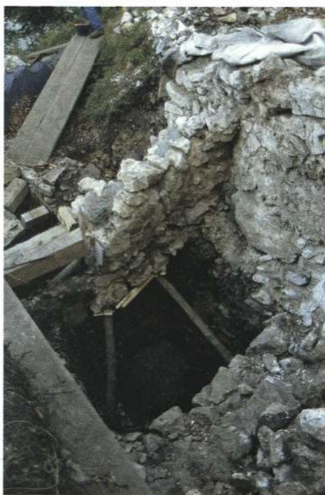
Odstranjena lizena, izpodkopani temelji kontrafora
