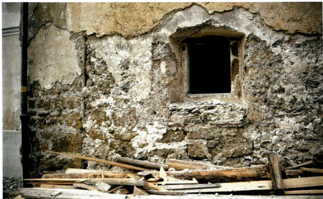
Vzhodna stena zvonika, v katero je vključena severna stena kvadratnega prezbiterja, foto N. Leben
