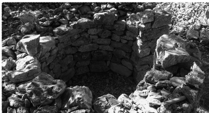
[15] Velika nosilnost zidu je zagotovljena z dobro izbranimi in vzdanimi kamni, enako pa velja tudi za skrbno polnjenje notranjosti zidu. F.: D. Okoren
