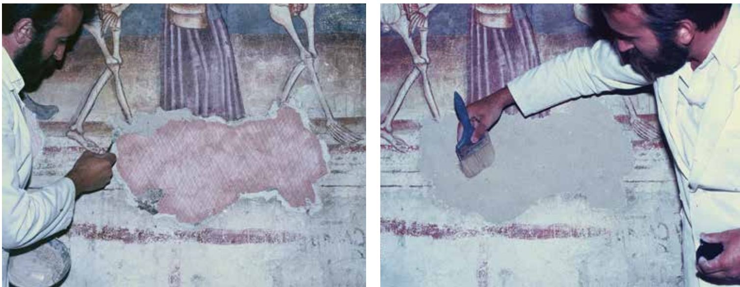
Sliki 5a, 5b: Večja poškodba na hrastoveljskem Mrtvaškem plesu Janeza iz Kastva (1490) levo med obdelavo z grobim rdečim ter čez tega desno še s finim dekorativnim ometom.
