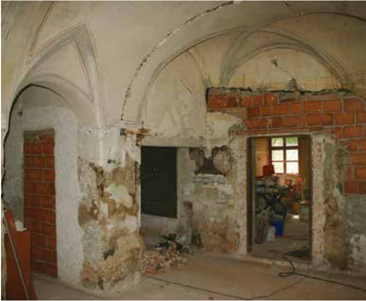
Slika 3: Prostor s poslikavo v Tavčarjevem dvorcu po odstranitvi sekundarnih plasti in dotrajanih neustreznih ometov.
