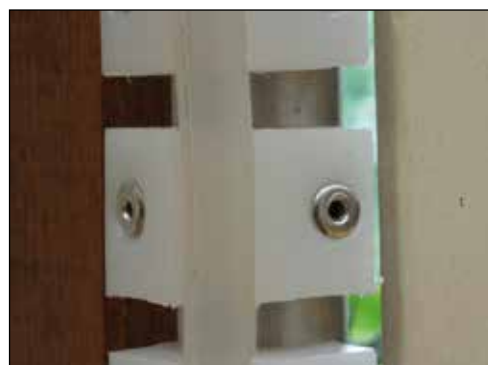
Slika 12: Razmik med aluminijastimi cevmi in leseno ploščo omogoča kroženje zraka. Plastični distančniki so s cevko zakovani v aluminijaste cevi podokvira.
