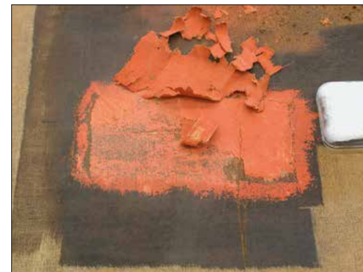
Slika 15: Mehansko odstranjevanje starih zaplat in rdečega minija, skozi katerega preseva star temen premaz.
