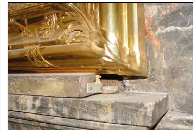
Fig. 2: La fessura in basso dove è visibile lo spazio della nicchia.
