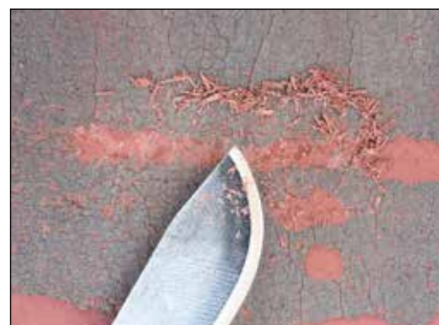
Fig. 7: Dopo l'asciugatura abbiamo trattato superficialmente e adeguato la struttura dello stucco emulsionato alla superficie originale.
