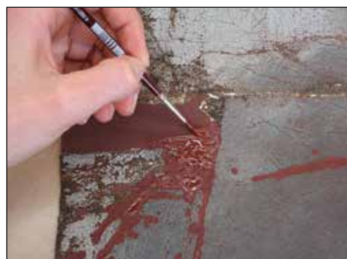
Fig. 6: Nel caso di lesioni profonde abbiamo steso in più strati un impasto denso, le piccole fessure sono state invece colmate con un amalgama più fluido applicato in un solo strato.
