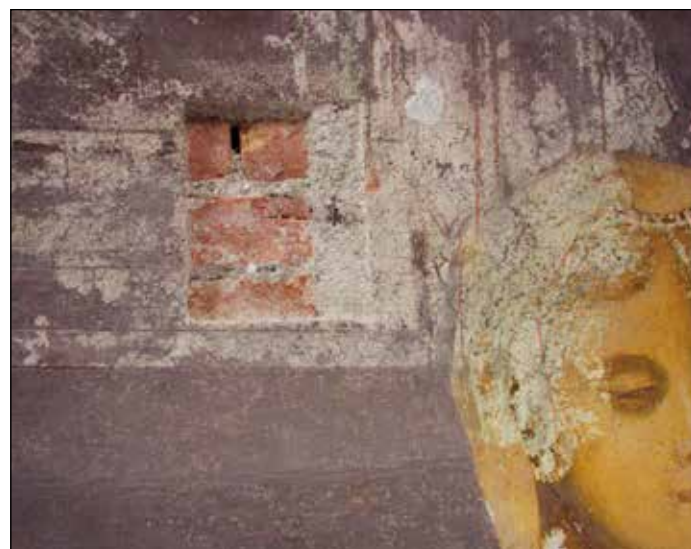
Slika 23: Poškodovana površina poslikanega oboka (lokacija H19)
