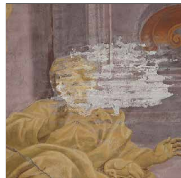
Sliki 18b in 18c: Pri povečavi detajla 18b iz celote 18a je okrog glave prve severne kreposti Dobrotnosti opazna sled zaradi dolgotrajnega zamakanja, ki je povzročilo uničenje: 18c – stanje leta 2004.
