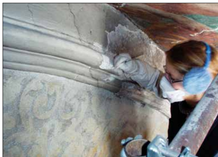
Slika 168: Odstranjevanje beležev – del Quaglijeve poslikave oboka prehaja na slavoločno steno. V zvezi s prehajanjem poslikave čez robove dejanske arhitekture je treba opozoriti na tridimenzionalne dodatke, ki smo jih našli na nekaterih predelih, navadno na robovih sosvodnic (oblaki, konec kraka Andrejevega križa itd.).
