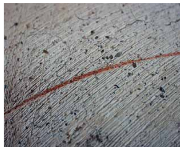
Slika 154: Tipična površina osnovnega premaza z apnenim beležem. Že tu, na še neposlikani površini, so vidni odkrušeni delci beleža, predvsem so vidni drobni temni kamenčki, verjetno sestavni del beleža. Mogoče pa je, da so te slabo pritrjene delce, ki bi drugače med slikanjem sami odstopili in motili slikanje, namerno odstranili s povrhnjice s krtačenjem površine (HUDOKLIN 1955, str. 39, sl. 37).
