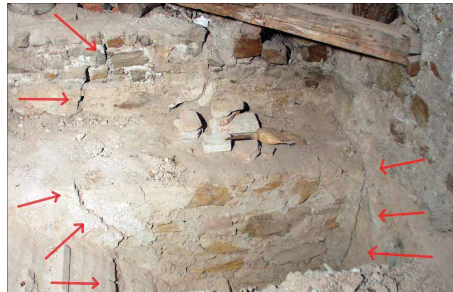
Slika 38: Raziskovalna sonda v SZ-kotu podstrešja z vrisanimi puščicami, ki na levi kažejo na močno razpoko, na desni pa odstopanje zidave.
