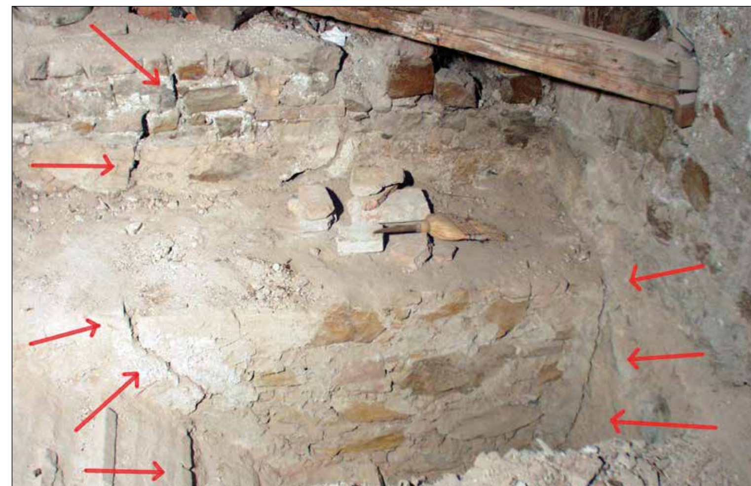
Fig. 38: Sondaggio esplorativo nell'angolo NO del sottotetto con le frecce che indicano a sinistra una notevole fessura, sulla destra il distacco della muratura.
