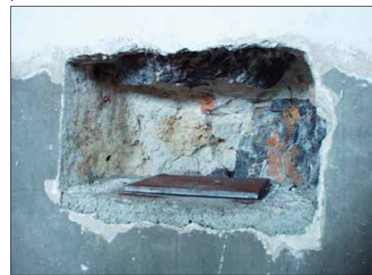
Fig. 28: L'incavo dovuto all'ancoraggio del ponteggio per il restauro.
