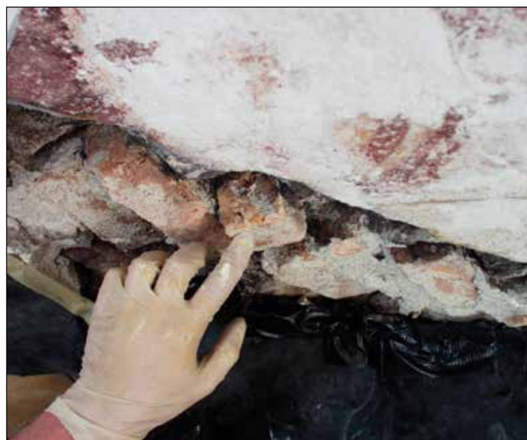
Fig. 89: Le ampie fessure nel punto di contatto tra il campanile settentrionale e la parete della navata.
