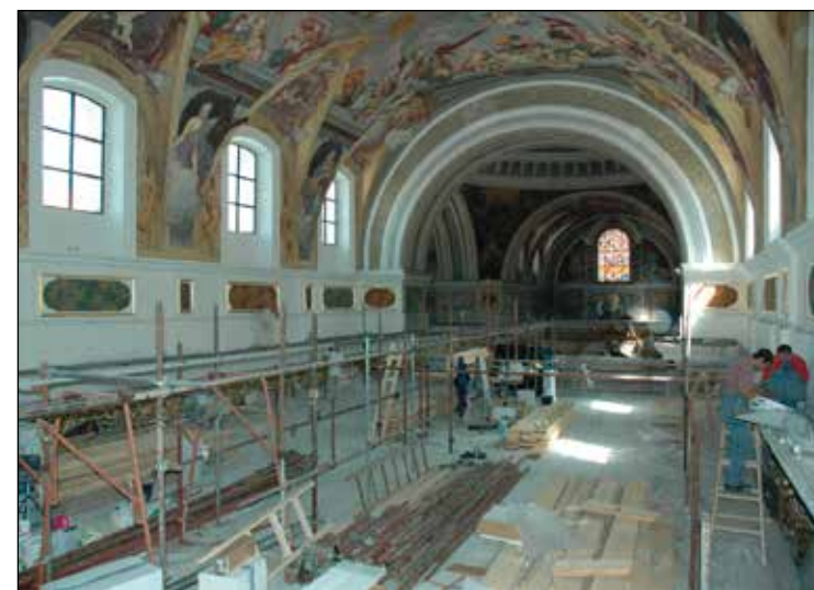
Fig. 237: La piattaforma per il restauro a 13 metri d'altezza dopo la rimozione della superficie di calpestio.
