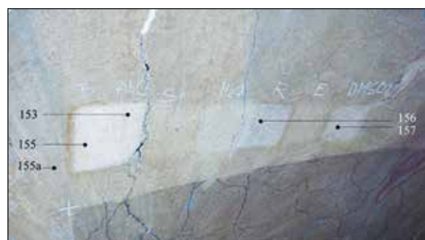
Fig. 1: Punti di prelievo dei campioni utilizzati per eseguire i test di pulitura chimica. 155a - prima della pulizia, 153 - dopo l'applicazione di \text{NH}_4\text{HCO}_3 , 155 - dopo l'applicazione di \text{NH}_4\text{HCO}_3 e consolidamento con \text{Ba}(\text{OH})_2 \cdot 8\text{H}_2\text{O} , 156 - dopo l'applicazione di resina a scambio ionico.
