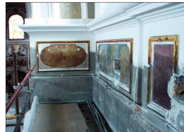
Fig. 238: Le aperture in cui erano alloggiati i supporti del ponteggio e le evidenti differenze tra le superfici pulite e non.
