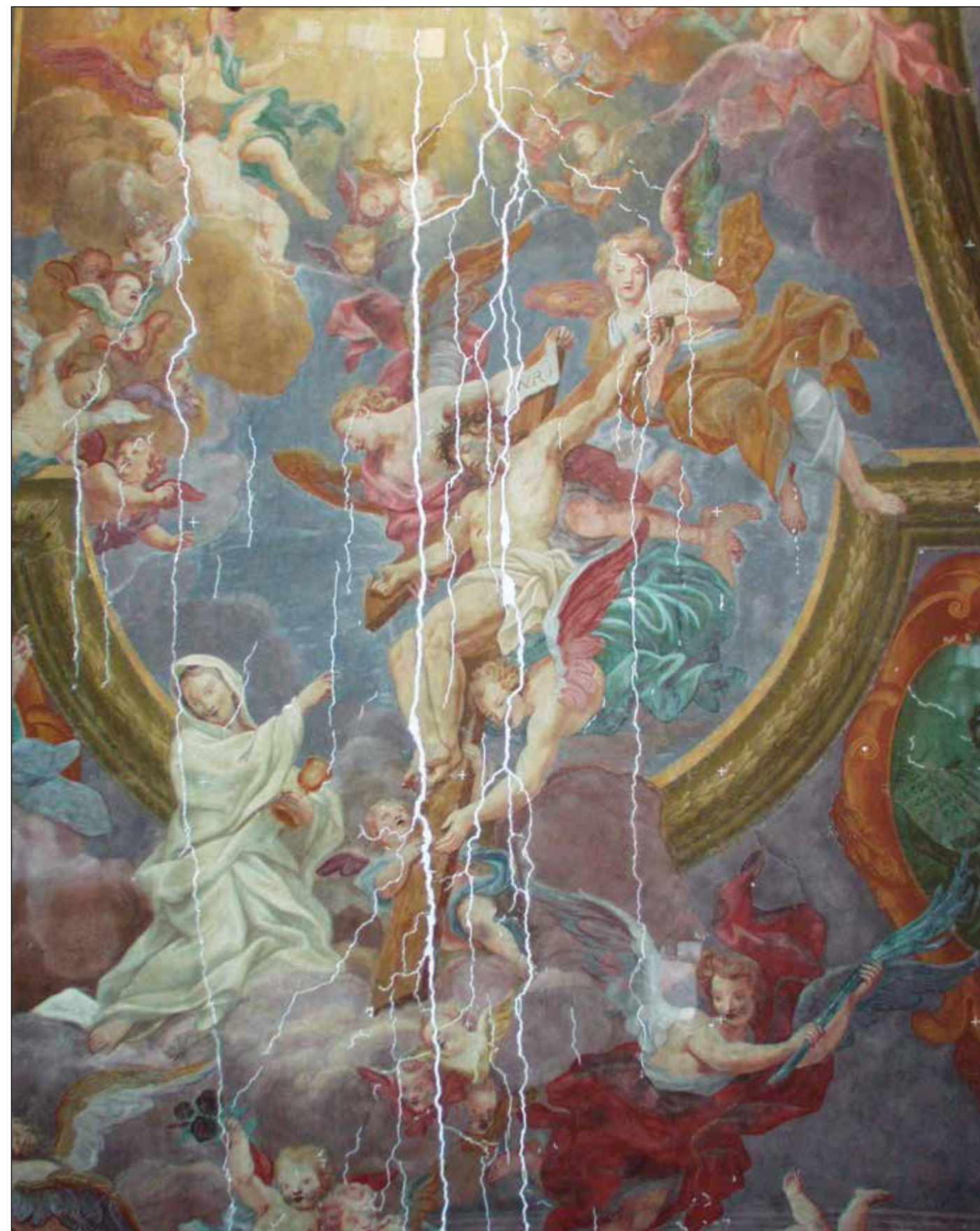
Fig. 72: Le fessure sigillate prima del ritocco.
