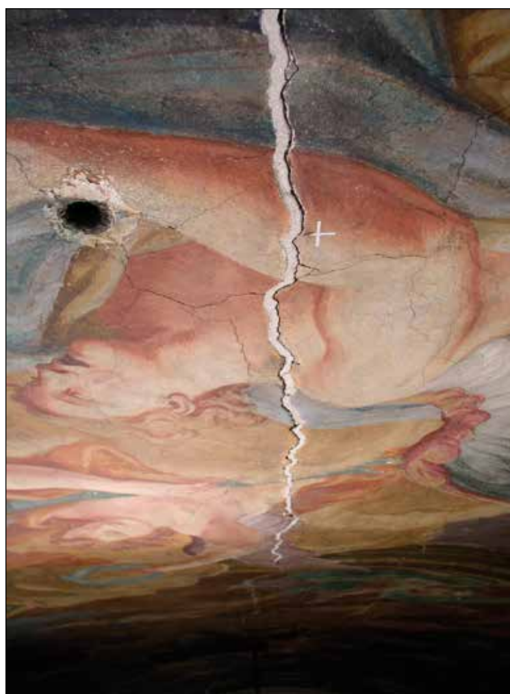
Fig. 32: Situazione prima dell'intervento – una nuova fessura, accanto a quella un tempo già sigillata, corre alternativamente da una e dall'altra parte della vecchia lesione.
