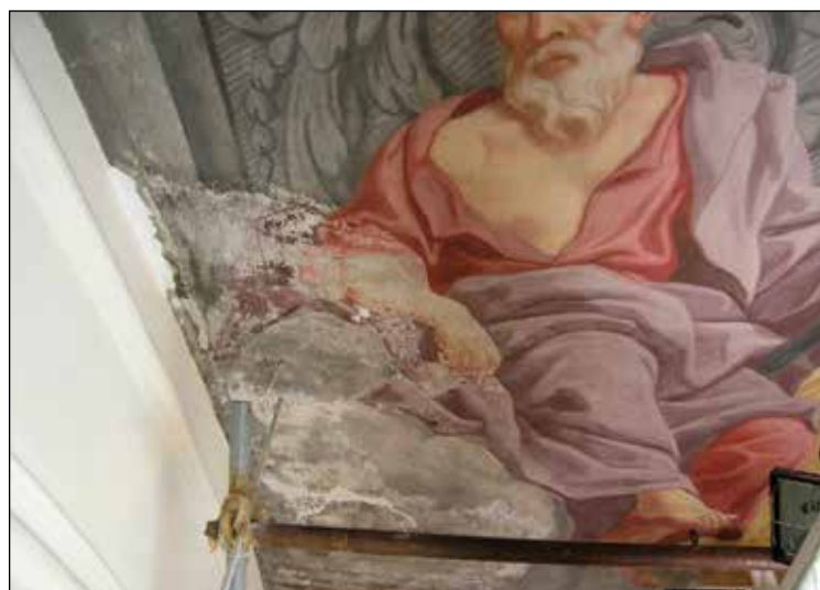
Fig. 94: Punto di contatto delle pareti N e O – le conseguenze delle infiltrazioni.
