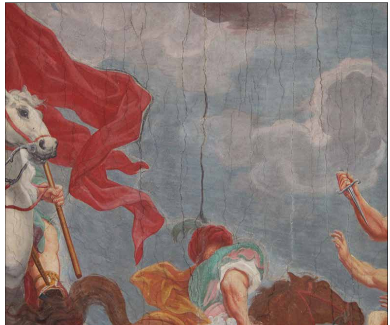
Fig. 203: L'area della volta sopra l'organo con il quadro fessurativo più fitto; al centro e a sinistra, accanto al drappeggio rosso, i ritocchi scuriti del precedente intervento di restauro.
