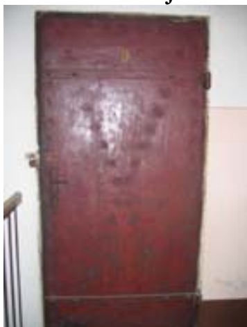
Požarna vrata št. 9
