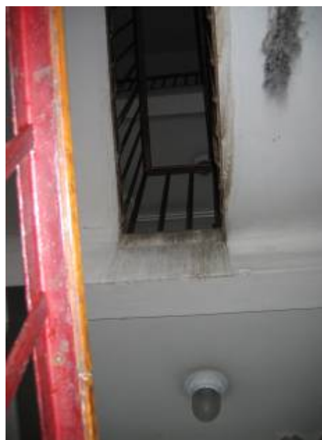
Poškodbe ometa na podnožju stopniščnih ram
