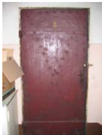
Požarna vrata št.8
