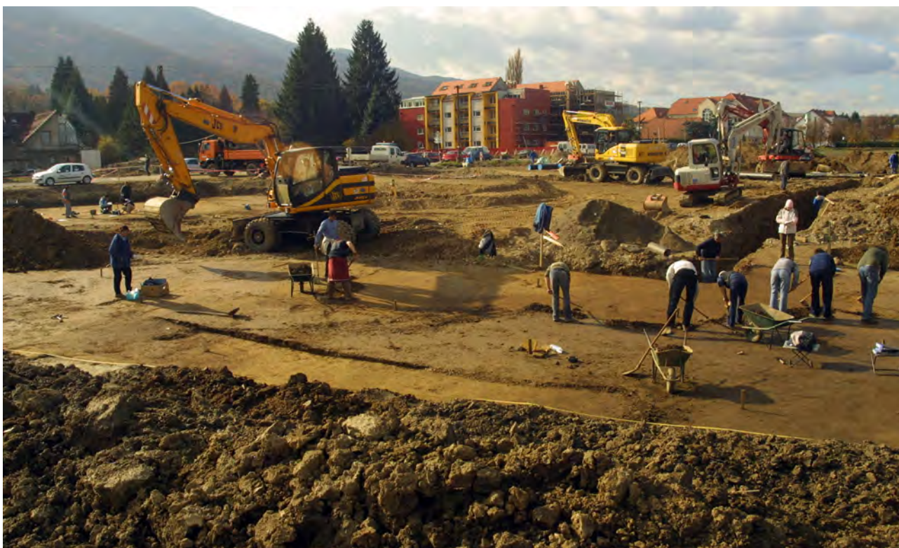
27 Naplavinska plast SE 232 = SE 334 = SE 352 nad objekti 2 in 3 v sek. 1 med strganjem; v ozadju pravkar izkopan jarek za vodovod(?). Pogled z vzhoda.
