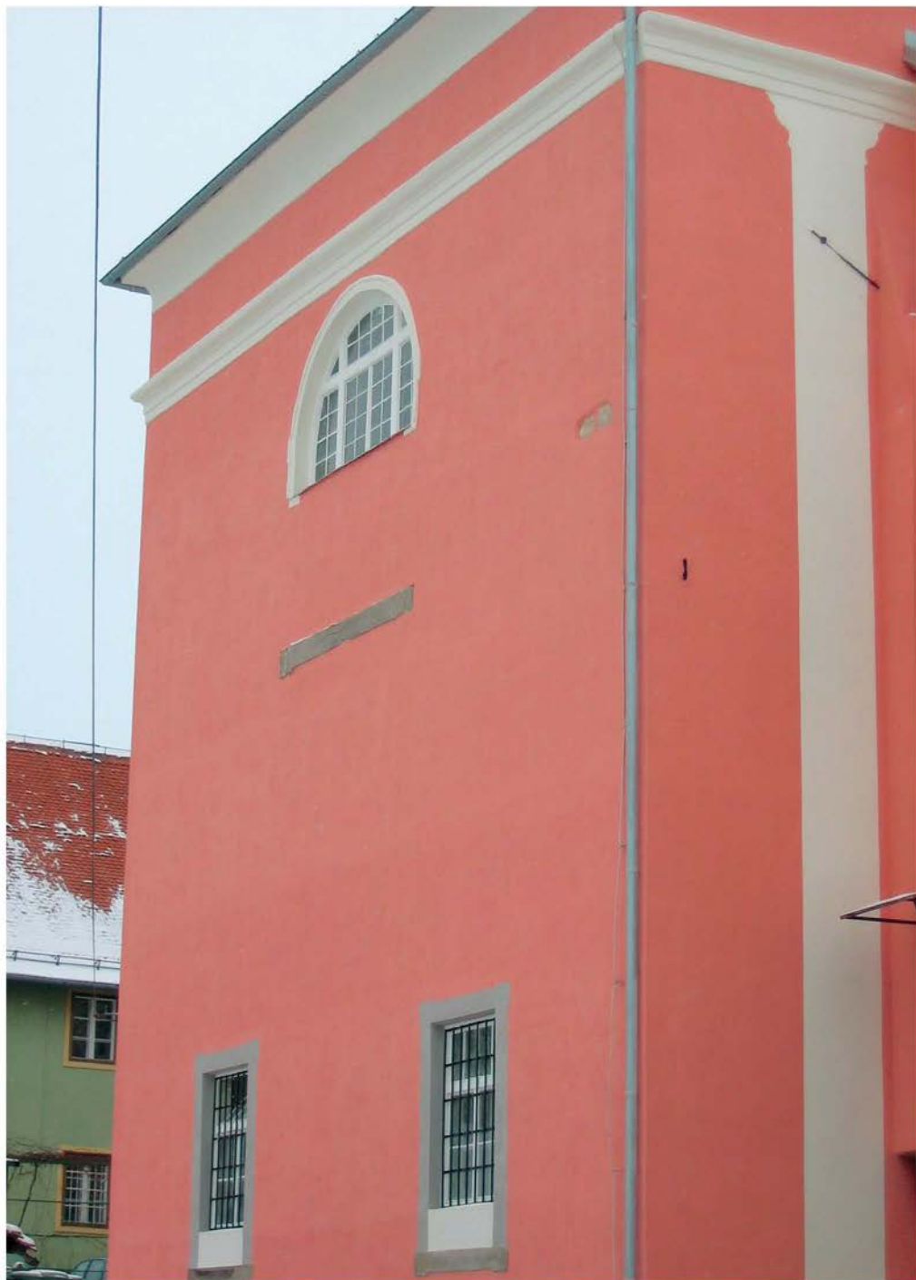
Ptuj, dominikanski samostan, zahodna cerkvena fasada z osrednjim polkrožno zaključenim oknom in okni nekdanje zakristije, ki jih bo treba ob obnovi notranjščine podaljšati do kamnitih polic (foto: M. Habjanič)
