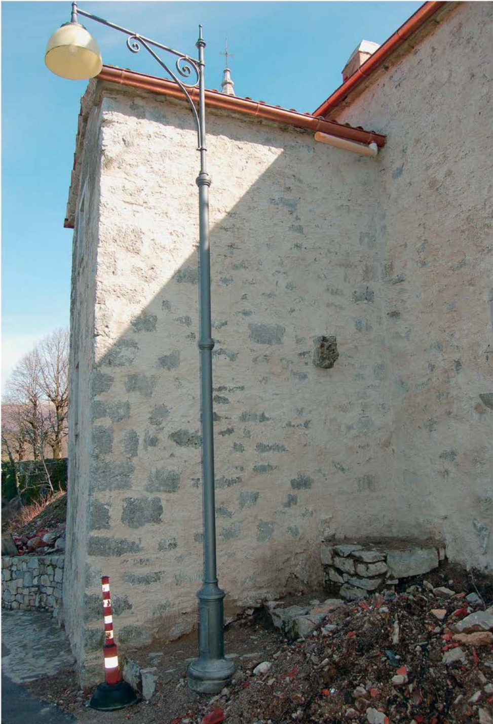
Škocjan, nekdanja kaplanija, del na novo pozidane stene prizidka retrofasade po nanosu ometov (foto E. Belingar, 2009)
