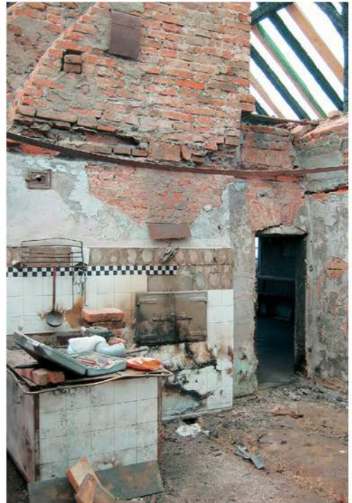
Hiša Grafonžove domačije v Zgornji Ščavnici, v požaru poškodovana hiša pred obnovo (foto: J. Skalicky, 2006)
