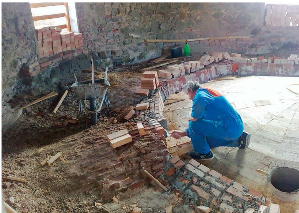
Rekonstrukcija opečnega oboka v stolpu št. 1 (foto: T. Golob, 2009, Arhiv ZVKDS, OE Novo mesto)
