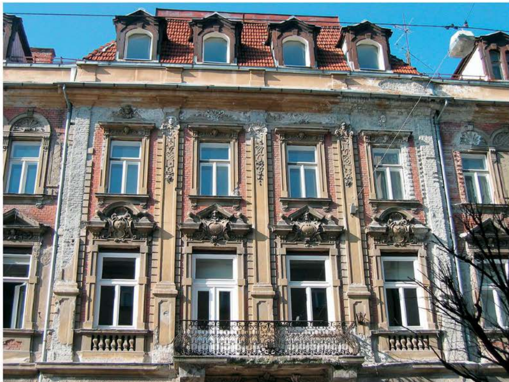
Poškodbe na fasadi hiše Prešernova 5 v Ljubljani z izvedenimi začasnimi ukrepi (foto: S. Ravnikar, 2007)
