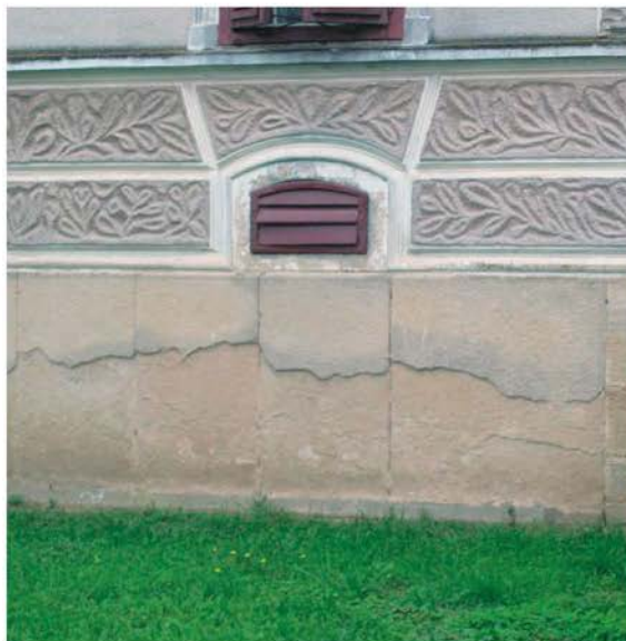
Vidno poškodovani temeljni zidec pred obnovo, avgust 2007 (foto: S.Vešligaj)
