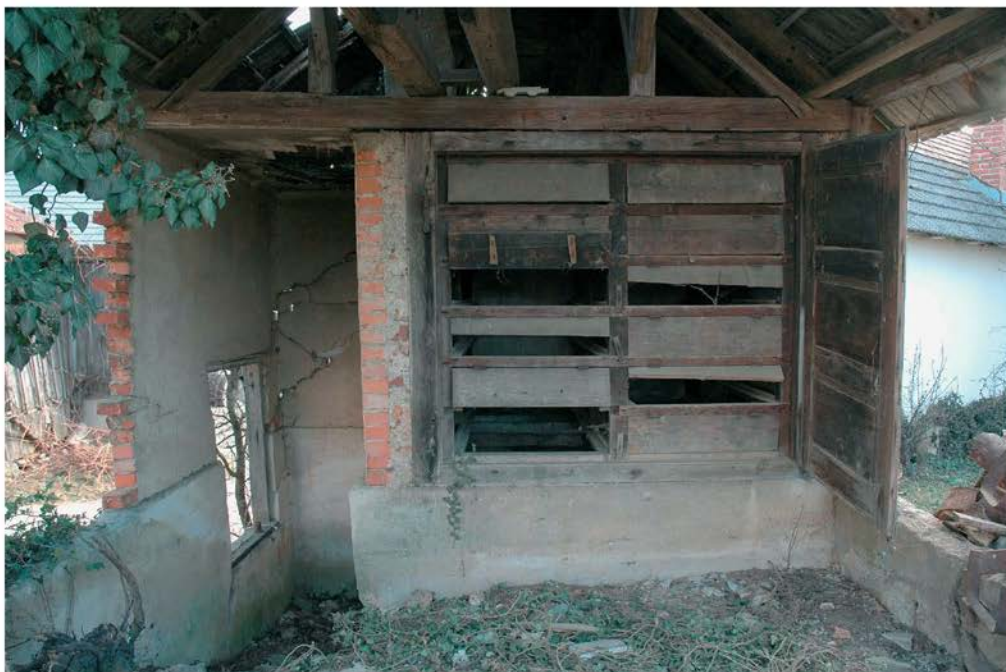
Pogled na propadajočo sušilno komoro v sušilnici (foto: D. Štepec, 2008, Arhiv ZVKDS, OE Novo mesto)
