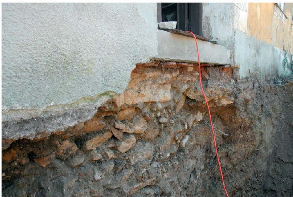
Brežice, hiša Prešernova cesta 5, stanje kletne stene ob zemeljskem izkopu (foto: D. Stregar)
