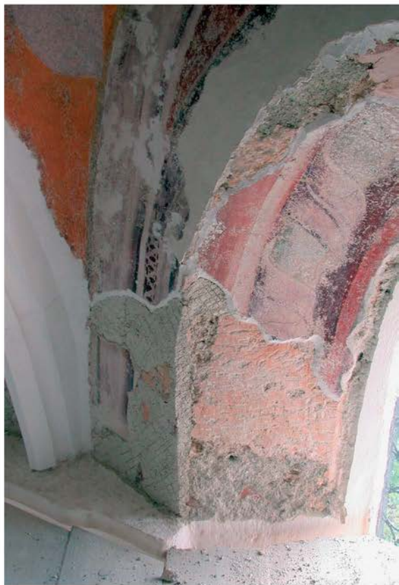
Stopno, cerkev Kraljice presvetega rožnega venca, prezbitterij: odkrivanje in kitanje poškodb (foto: T. Mesojedec)
