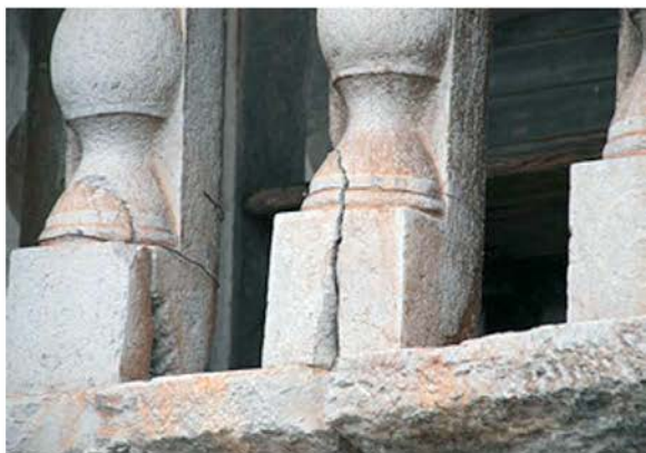
Detalji poškodovane balustrske kamnite ograje pred restavriranjem (foto: A. Naglost, 2008)
