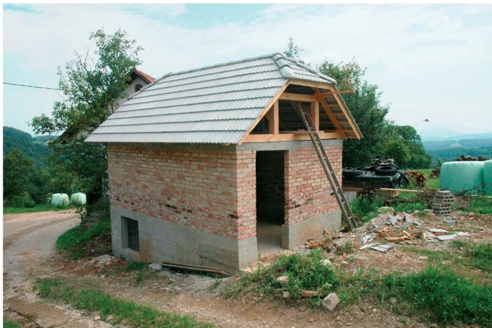
Obnovljene obodne stene sušilnice in njena streha (foto: D. Štepec, 2008, Arhiv ZVKDS, OE Novo mesto)
