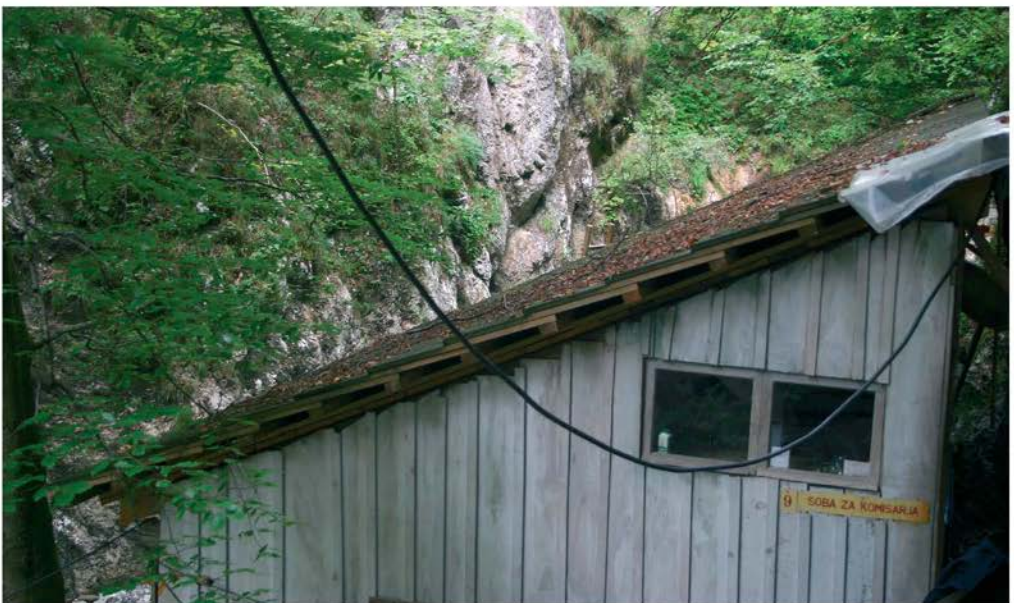
Stanje strehe na baraki št. 9 pred posegom (foto: E. Drole, 2008)
