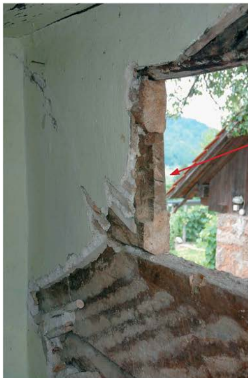
S puščico je označeno mesto nekdanje okenske odprtine (foto: D. Štepec, 2008, Arhiv ZVKDS, OE Novo mesto).
