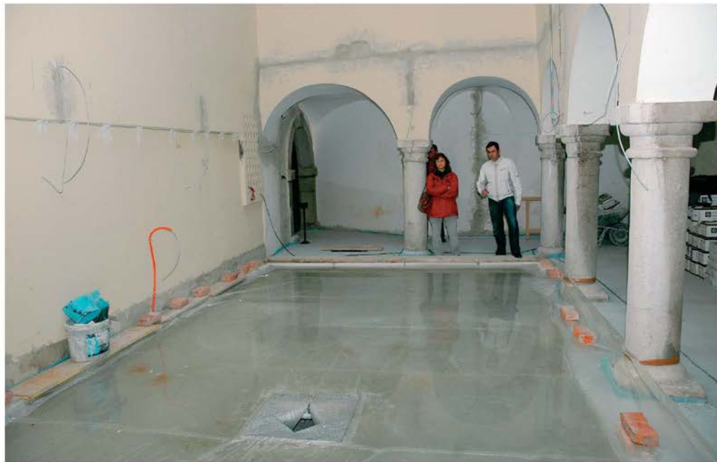
Novo mesto, hiša Glavni trg 24, stanje v arkadnem hodniku po nedovoljeni odstranitvi prvotnih tlakov (foto: T. Golob)
