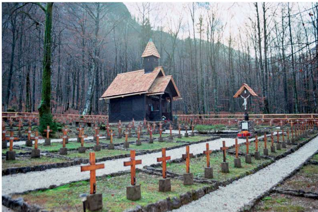
Ukanc, vojaško pokopališče iz prve svetovne vojne, obnova strehe na kapeli in križu (foto: R. Pamić)
