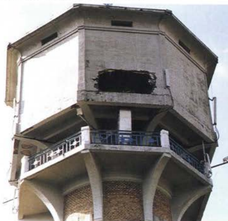
Poškodba betonske stene (foto: R. Pamić)
