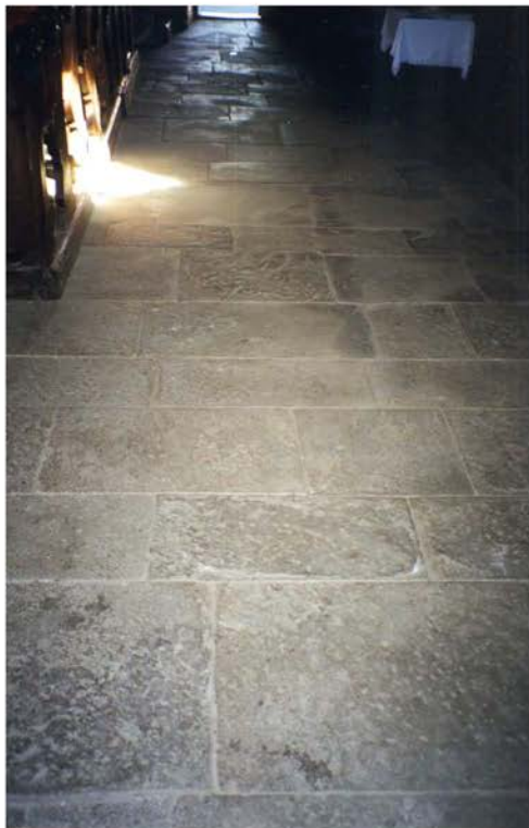
Kamniti tlak v ladji pred odstranitvijo, pogled proti glavnim vratom (foto: A. Zeleznik)
