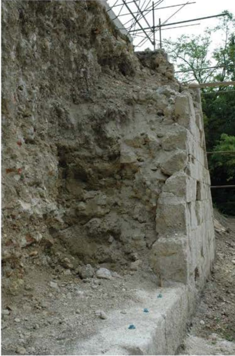
Podporni zid po zrušitvi (foto: Tomaž Golob)
