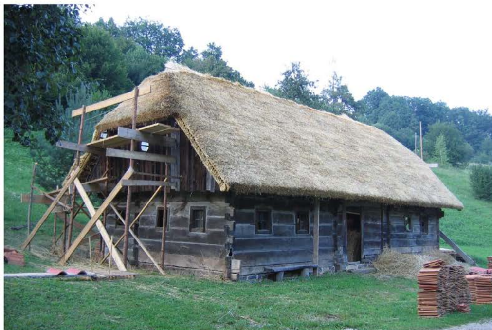
Prestavljena hiša z novo slamnato kritino, avgust 2005 (foto: D. Strgar, arhiv ZVKDS, OE NM)
