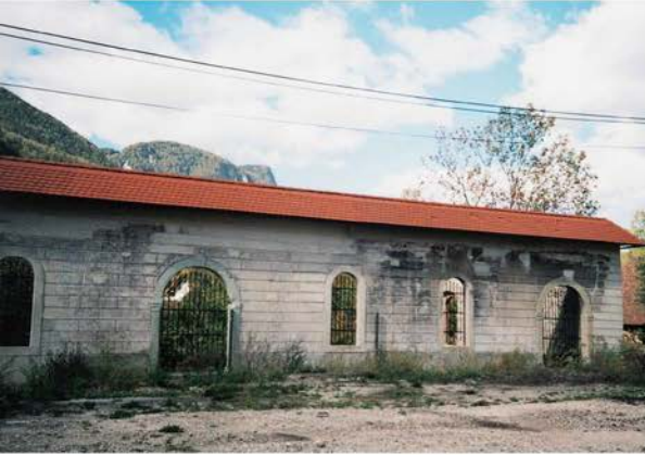
Jesenice, Pudlovka na Stari Savi, vhodna fasada Pudlovke na Stari Savi, obodni zid po obnovi z zaščitno streho. Stanje leta 2004. Foto: V. Knific
