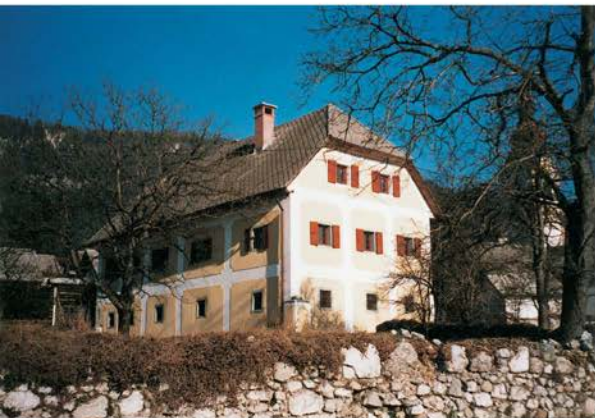
Rodine št. 11, zidana nadstropna hiša po obnovi fasade. Stanje leta 2001. Foto: D. Pečnik
