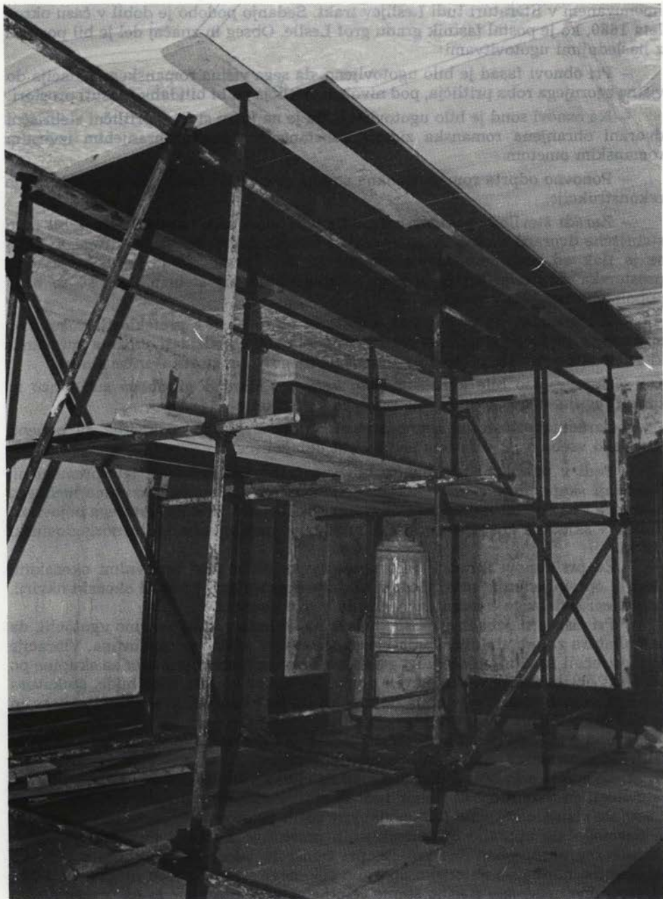
Sl. 32. Ptujski grad, varovanje štukature med montažo razbremenilnega stropa Fig. 32. Ptujski grad – protection of stucco during the fitting up of discharging ceiling
