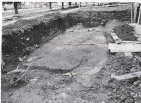
Sl. 104 Ptuj, nova avtomehanična delavnica ob Rajčevi ulici – pogled na očiščeno sondo pred nekdanjo kovinarsko delavnico
