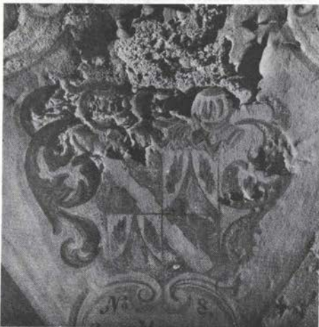
Sl. 176. Ljubljana, grajska kapela – poškodbe na poslikavi (f. V. Benedik)
