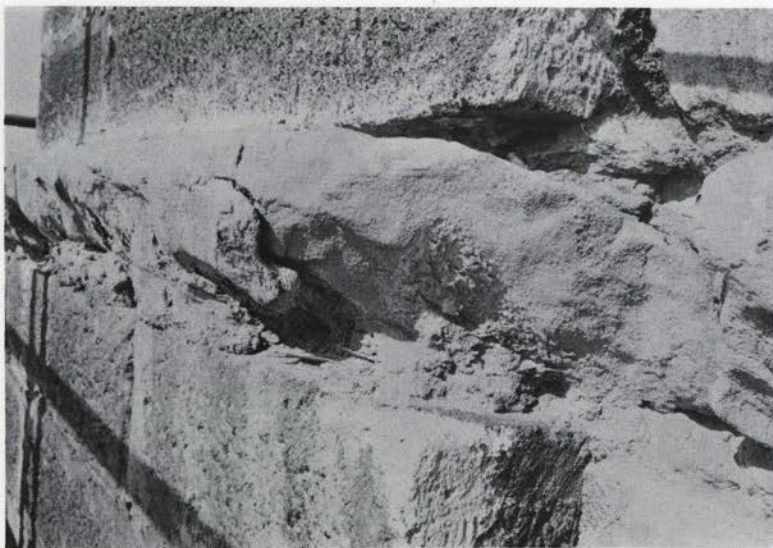
Sl. 41. Ptuj – Mestni stolp: detajl, uničeni mejni zidec (f. J. Mikuž) Fig. 41 – Ptuj – Town Tower: detail of the damages
