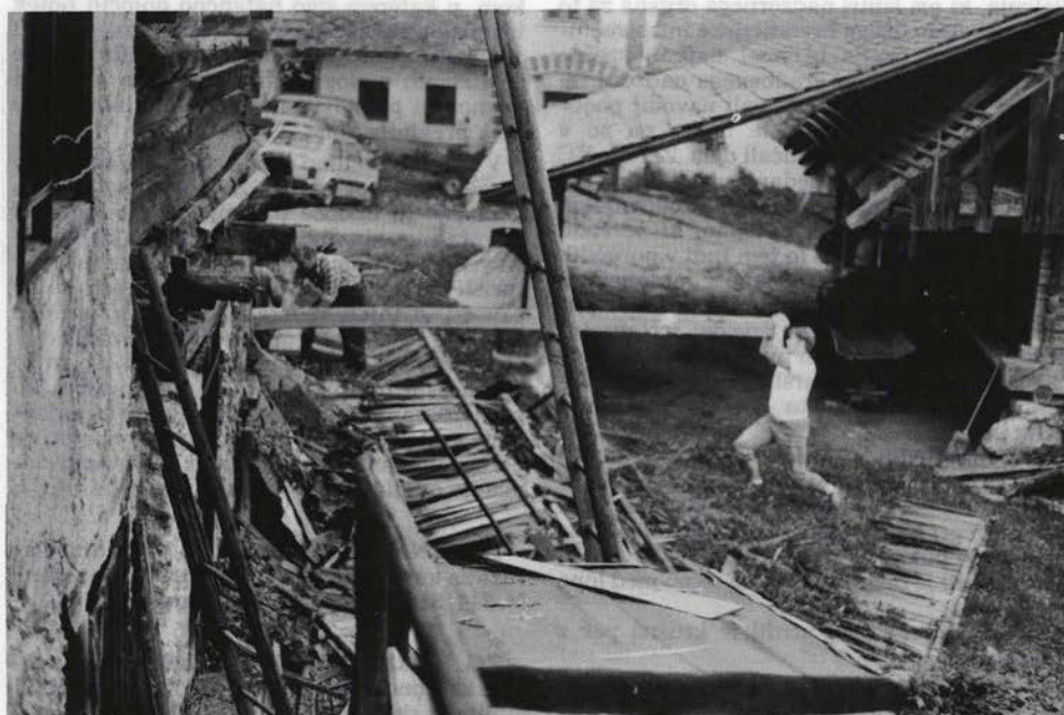
Sl. 110 Zg. Palovče 5, pri Matjaž – vzvodno dviganje »poda« za lažjo zamenjavo nosilnega tramu (ZVNKD Kranj 1989) Fig. 110 Zg. Palovče 5 – construction renewal of the barn
