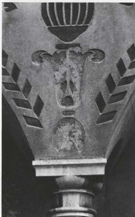
Sl. 28. Ljubljana, Križanke, sgraffito kot primer dekorativne fasadne slikarije (slabši omet je razpadel, f. I. Bogovčič)
