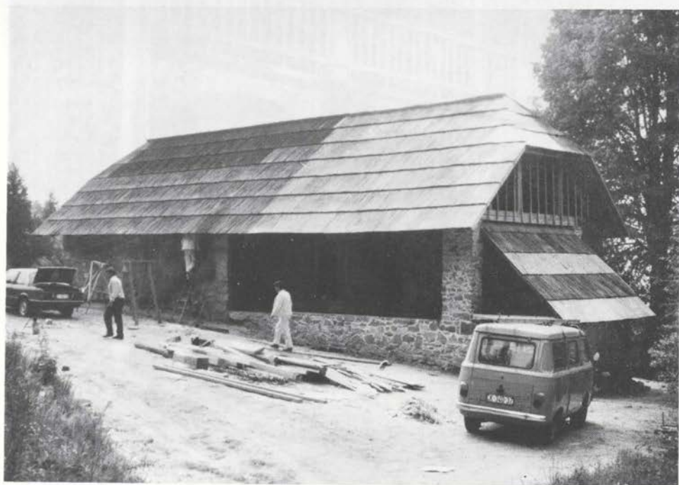
Sl. 25. Zavodnje — zaščita lesenih elementov na Kavčnikovi domačiji — dimnici Fig. 25 — Zavodnje — protection of wooden elements in the Kavčnik home — smoke-room
