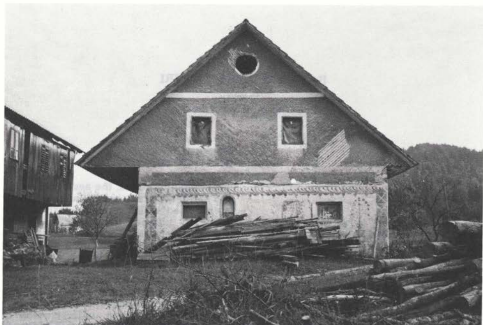
Sl. 19. Zavratac, hiša, l. 1921 spremenjena v svinjak. Zaradi izsoljevanja se razpad tudi po restavriranju nadaljuje (f. I. Bogovčič l. 1985)
