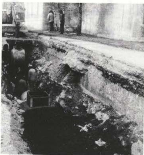
Sl. 5. Jesenice — gradbena jama za kanalizacijski vod in kamnita stena vodnih rak pri fužinarski kapeli
