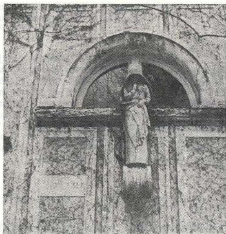
Sl. 76. Močno poškodovane okenske police in poškodba ometa posledica tipalk pope-njalke
