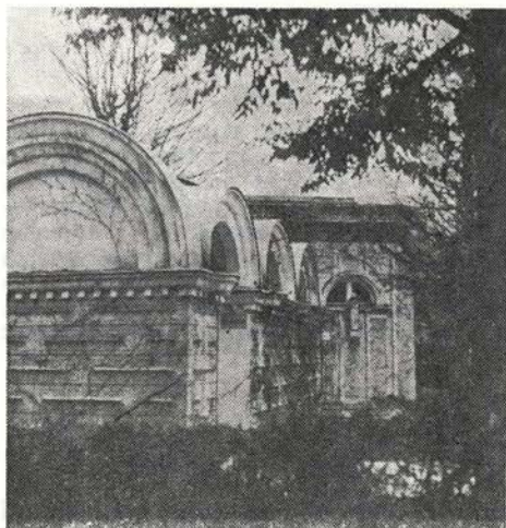
Sl. 75. Manjkajoče odtočne cevi — kapela sv. Andrej
