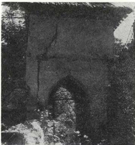
Sl. 77. Grabče, Strojova kovačnica detalj poškodb na stolpu
