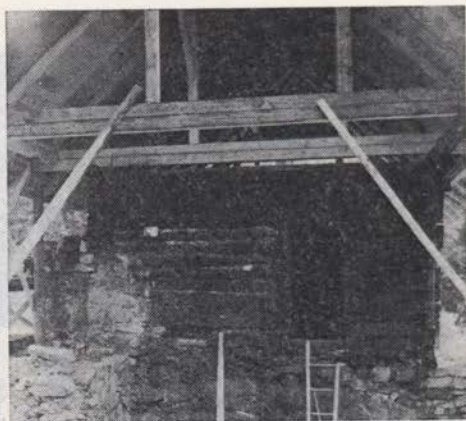
Sl. 159. Zavodje 43. Pogled na dimnico (kuhno). Posnetek je iz časa obnove stavbe, še pred sanacijo vhodne lope
