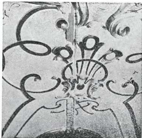
Sl. 35. Zagreb, HNK — poškodba zaradi kovinske konstrukcije lož
