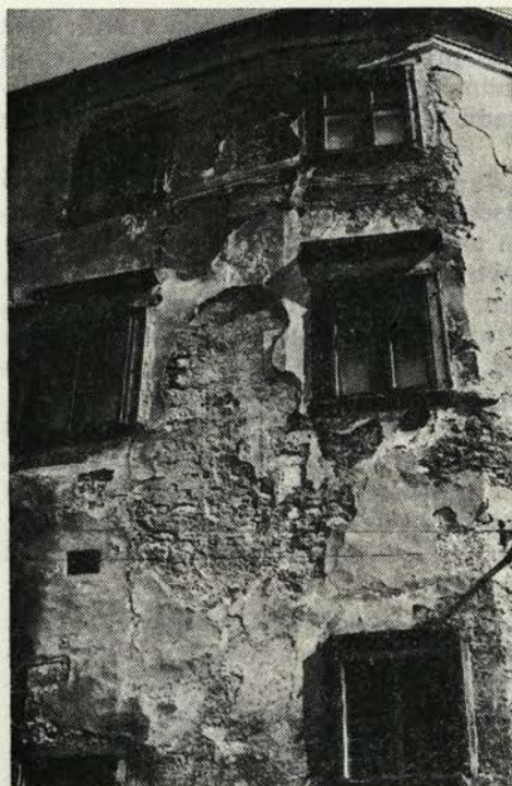
Sl. 36 Ptuj — poškodovana zahodna fasada osrednje grajske stavbe
