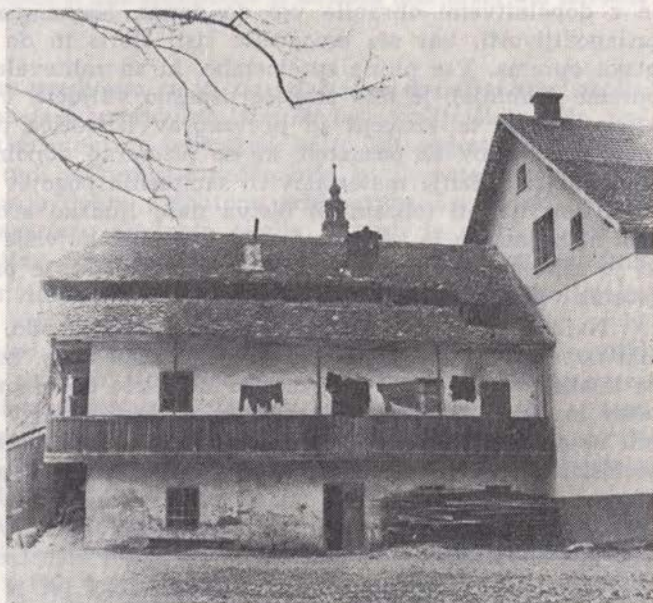
Sl. 9 Razpadajoči zadnji spomenik usnjarske obrti v Kamniku je »Usnjarska« hiša v Parmovi ulici
