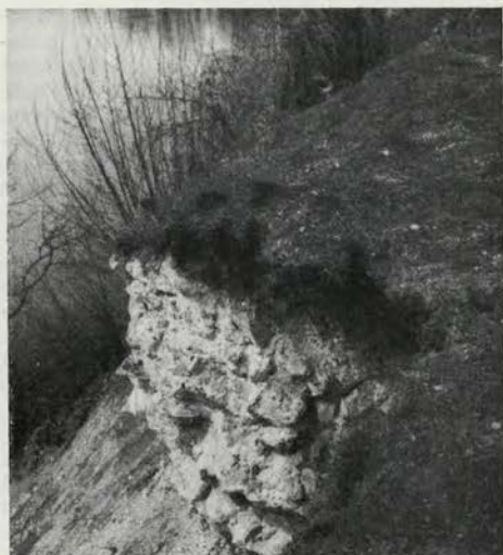
Zalog, pogled na spodkopane temelje obzidja. — Foto J. Gorjup
