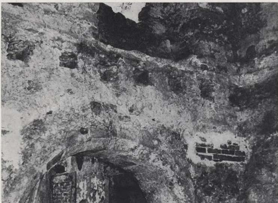
Otočec — pri odstranitvi baročnega oboka v pritlični veži so bila odkrita ležišča srednjeveškega lesenega stropa (foto: M. Mušič)
