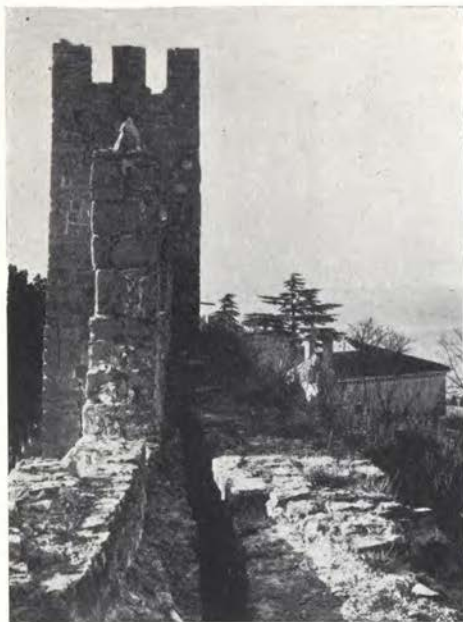
Piran — mestno obzidje, zaradi slabih temeljev se dodani del zidu ločuje od starejšega obzidja. (Foto M. Zadnikar)
