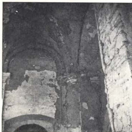
Kostanjevica na Krki — razpoke na steni in na oboku v severni stranski ladji. (Foto M. Čanak)
