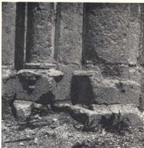
Kostanjevica na Krki — poškodbe na bazah kamnitih slopov. (Foto M. Canak)
