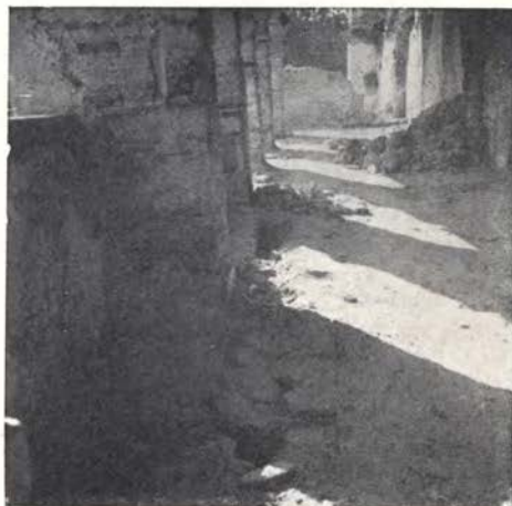
Kostanjevica na Krki — razpoke v tlaku prvega nadstropja arkadnega hodnika ob južni strani cerkve. (Foto M. Čanak)
