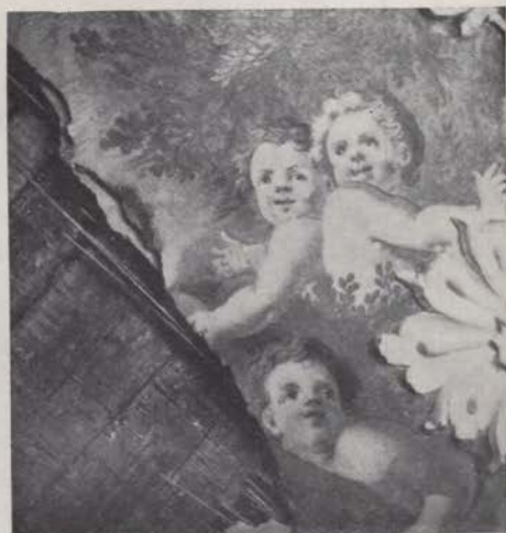
Hrastovec — po požaru poškodovan štukiran in poslikan strop nad baročnim stopniščem. (Foto: M. Zadnikar)
