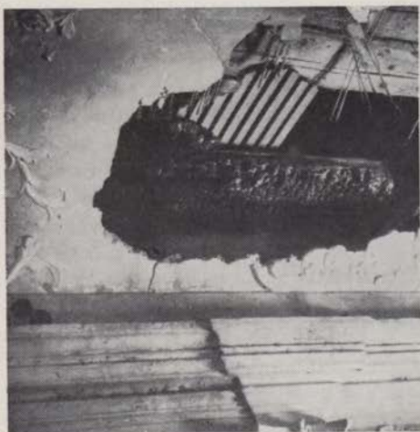
Hrastovec — po požaru poškodovani strop z baročnimi freskami. (Foto: M. Zadnikar)
