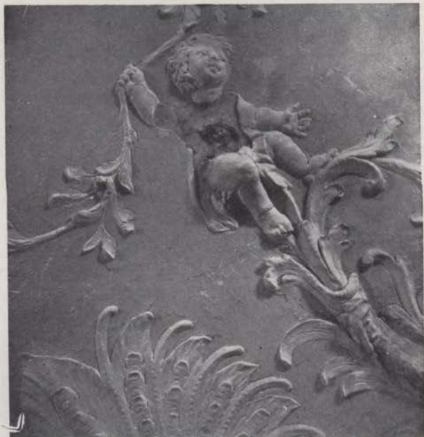
Hrastovec — okvare na štukiranem stropu nad stopniščem. (Foto: M. Zadnikar)
