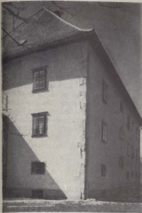
Napačna obravnava ometa je dovedla do pohabljenja spomeniške arhitekture. Površina ometa je zravnana in mrtva, za njo ni čutiti zidu, a posebno neustrezna je obravnava »šivanega« oгла. (Codellijev grad v Ljubljani, obnovljen leta 1954)
