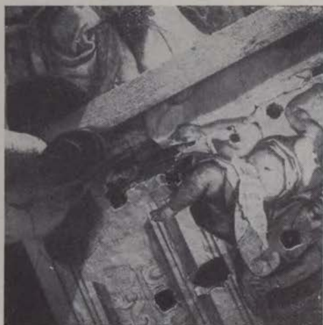
Sl. 25. — Brežice, grad, detajl s težkimi poškodbami na slikovni površini, ometu in opažnih deskah močno povešenega dela stropa
