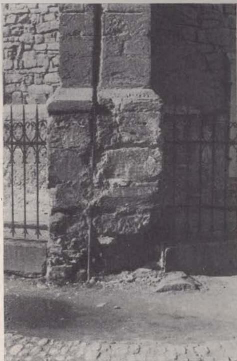
Maribor — stolnica — močno defektni opornik je potrebno izmenjati in ga tako statično utrditi. (Foto: Zadnikar)
