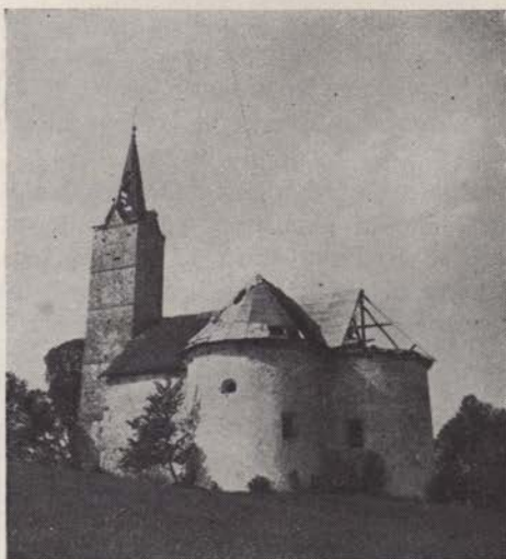
Zelše pri Cerknici — zunanjščina z defektno streho. (Foto: Zadnikar)
