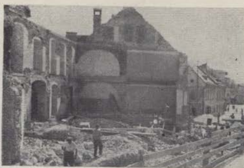
Sl. 7. Porušeni obcestni trakt »Stare Kresije«
