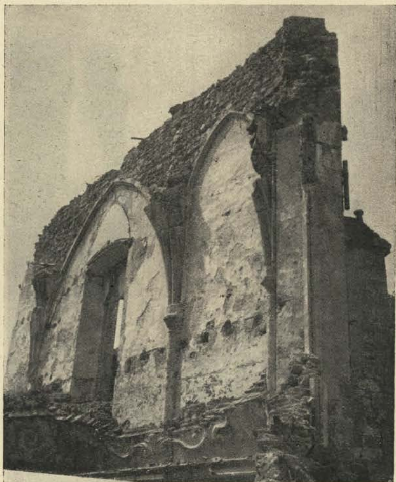
Ptuj — minoriti. V severni steni prezbiterja so ohranjeni vsi elementi prvotne obočne konstrukcije. Zazidani vrh gotskega okna učinkuje kot slepo oko v steni. (Foto avg. 1950 — Zadnikar)
