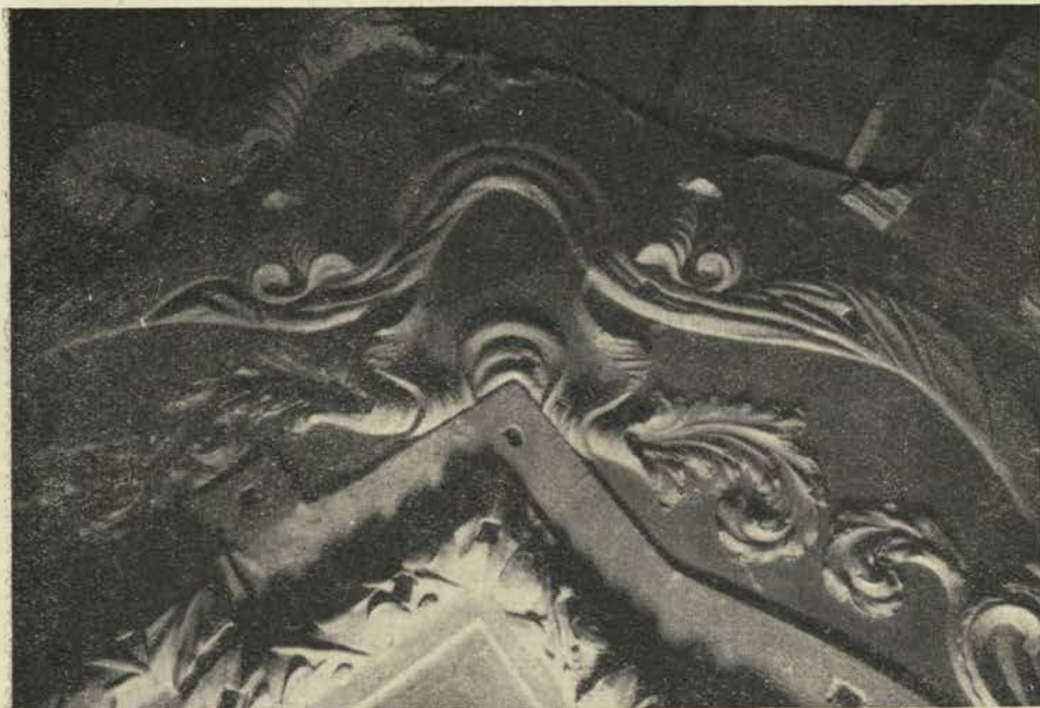
Grad Statenberg. Na stropu pete sobe je štukatura odpadla v celih ploskvah (ob spodnjem robu slike!), katero je bilo treba nadomestiti. (Foto Velepíč)
